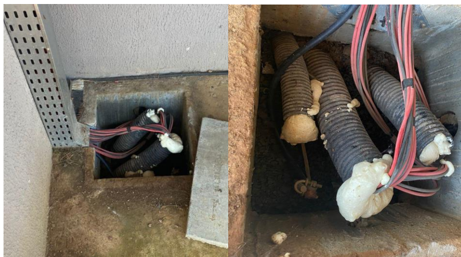
Figura 22 - Caixa de passagem com haste de aterramento
