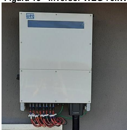
Figura 15 - Inversor WEG 75kW
