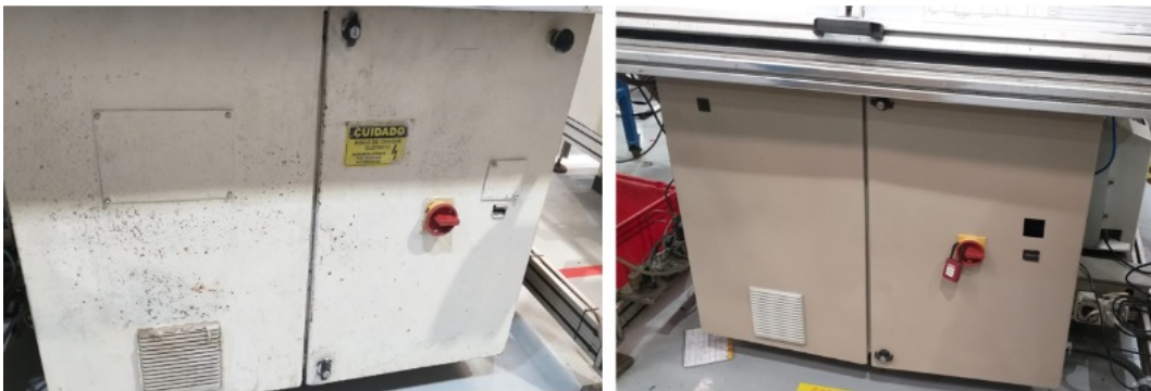
Figura 64 – Painelelétrico antes e depois.
