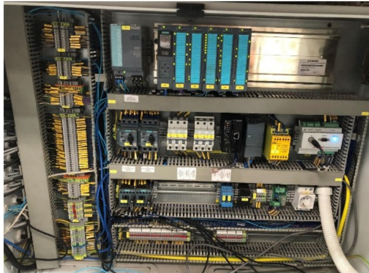
Figura 32 – Painel elétrico com CLP SIEMENS S7-1500.
