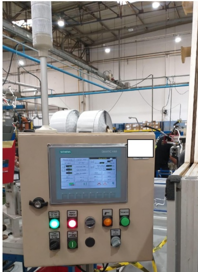
Figura 44 – Painel novo da IHM instalado.
