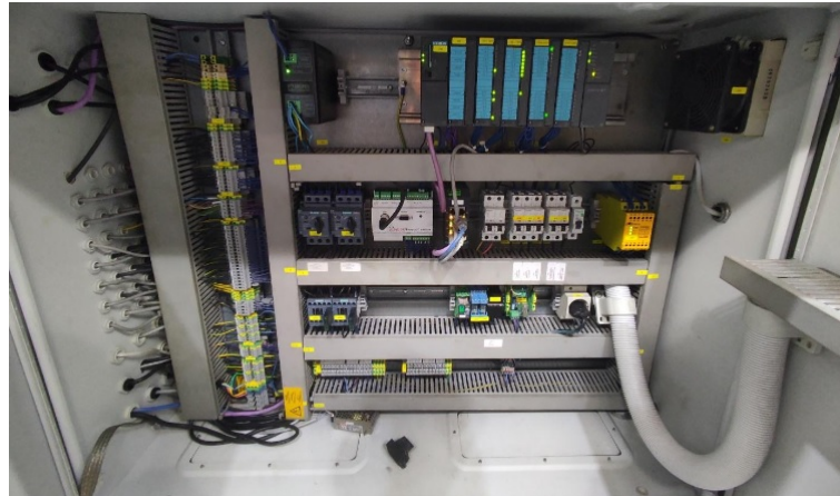
Figura 30 – Exemplo de painel elétrico.
