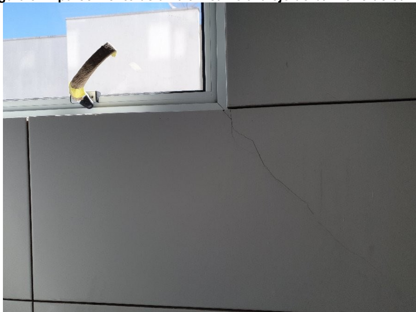
Figura 9 - Aparecimento de uma trinca no azulejo do banheiro do edifício
