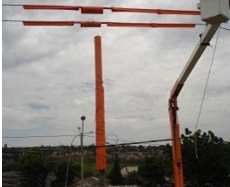
Figura 20 - Cobertura em poste sendo levantado e em condutores de média tensão
