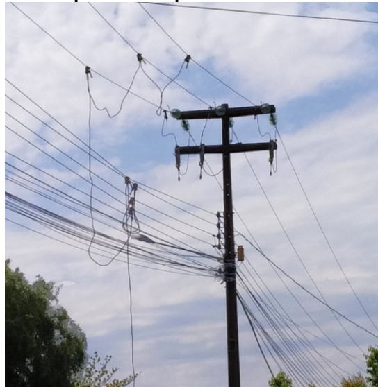
Figura 35 - Aterramento temporário em poste com chave-fusível aberta pela COPEL
