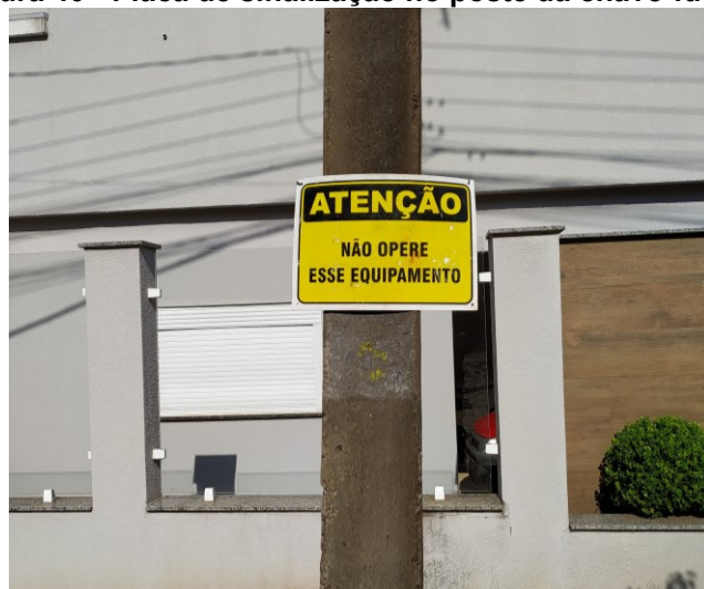
Figura 40 - Placa de sinalização no poste da chave-fusível
