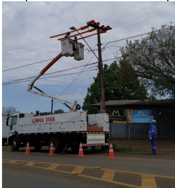
Figura 33 - Ponto próximo a chave seccionadora aberto pela linha viva
