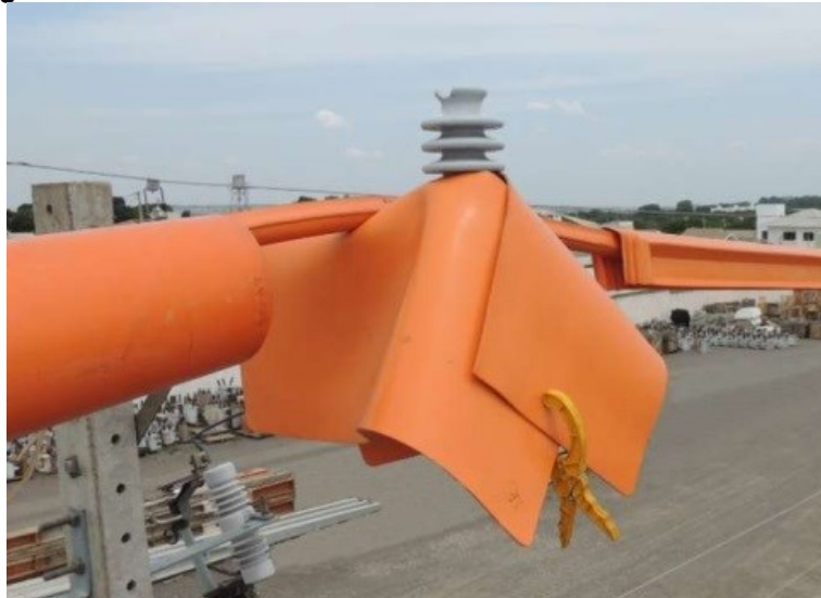
Figura 19 - Cobertura em cruzeta com condutor de média tensão
