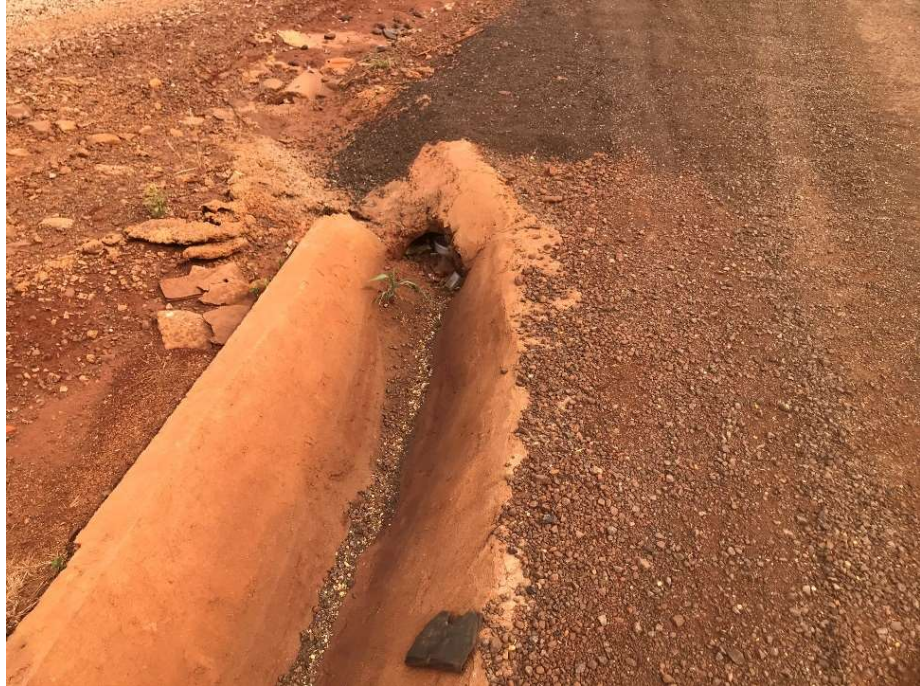
Figura 27 – Drenagem superficial sem limpeza.
