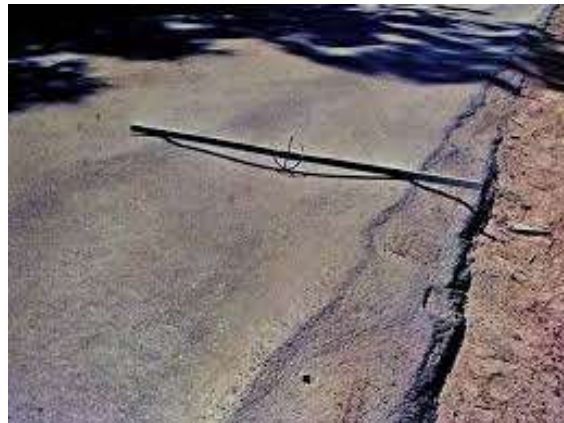
Figura 8 – Afundamento de trilha de roda.
