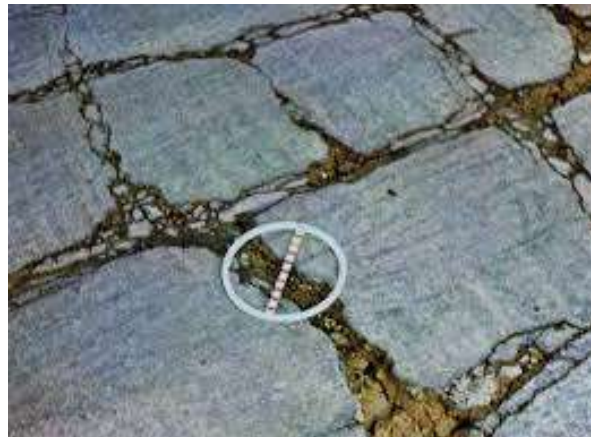
Figura 7 – Trinca interligada – tipo bloco.
