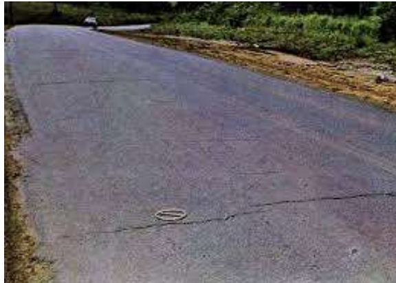
Figura 4 – Trinca isolada transversal.
