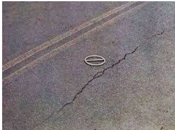
Figura 5 – Trinca isolada longitudinal.
