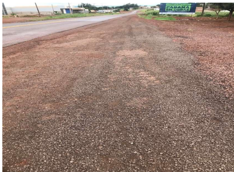
Figura 28 – Rodovia sem sistema de drenagem.
