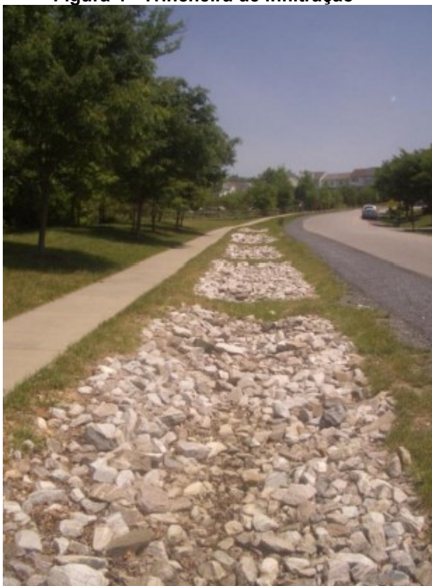
Figura 4 - Trincheira de infiltração
