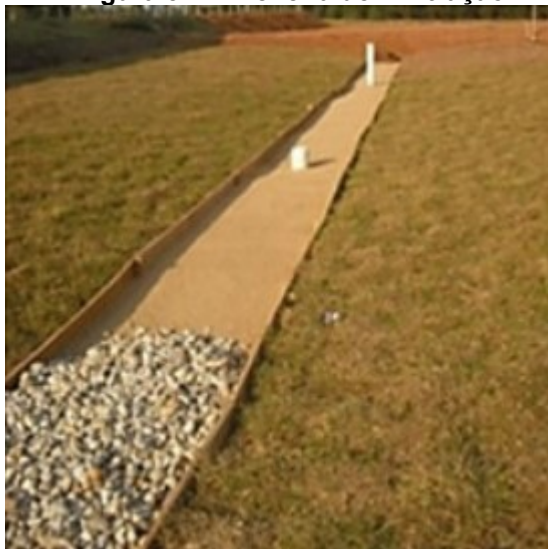
Figura 5 - Trincheira de infiltração
