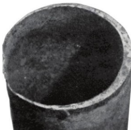
Figura 1 - Tubo apresentando corrosão severa
