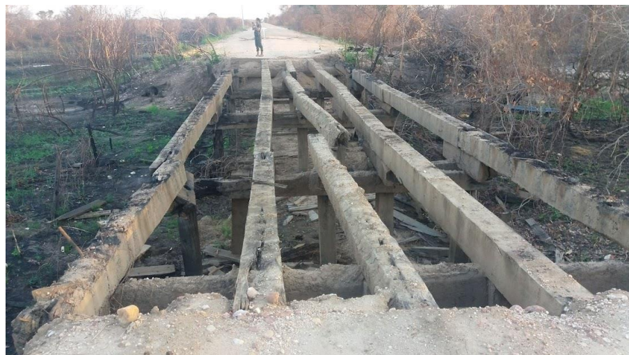
Figura 8- Ponte queimada na estrada Transpantaneira.
