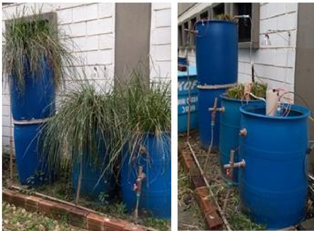
Figura 10: Imagens dos WCVA plantados com capim Vetiver , antes e após o corte, no 547º dia de operação
