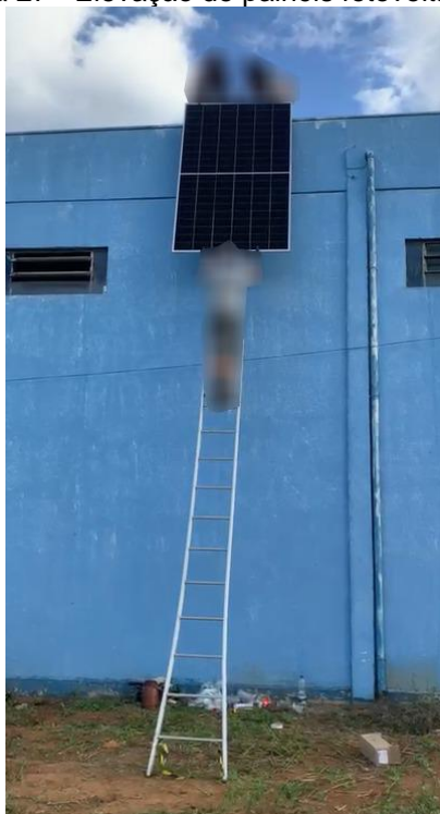
Figura 27 - Elevação de painéis fotovoltaicos
