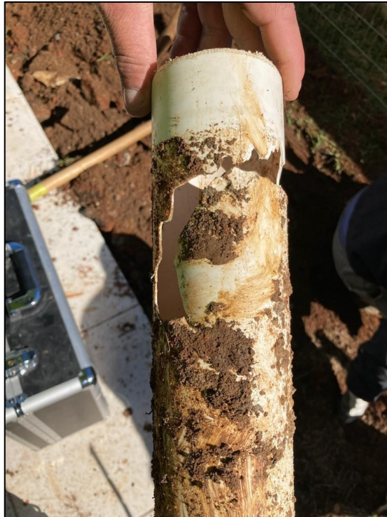
Fotografia 5 – Tubulação de esgoto enterrada rompida.
