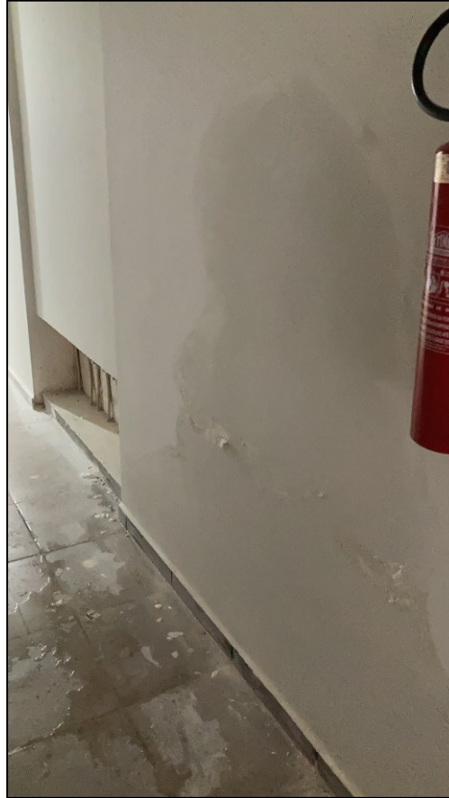
Fotografia 1 – Vazamento em instalação de água fria.
