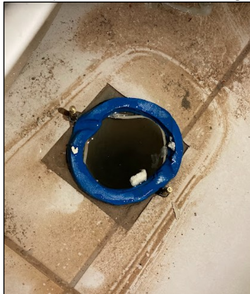
Fotografia 3 – Entupimento em tubulação de esgoto sanitário.
