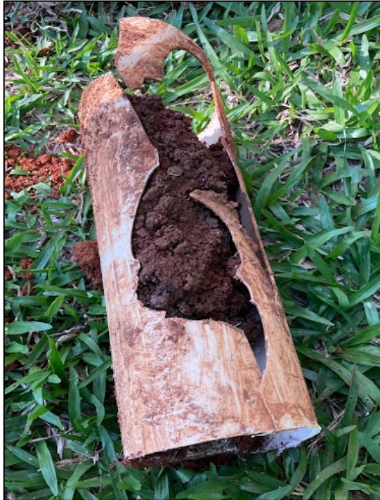
Fotografia 4 – Tubulação de esgoto enterrada rompida.
