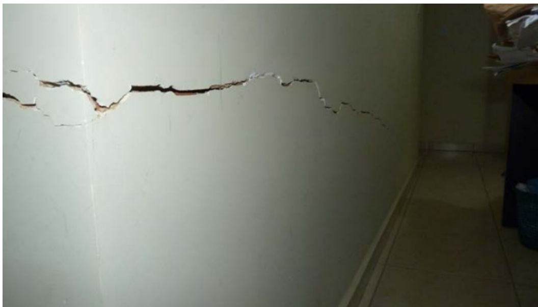
Figura 6 – Rachadura do painel do quarto suíte
