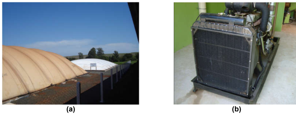
Figura 8 - Imagens ilustrando: a) Biodigestores e b) Motogerador
