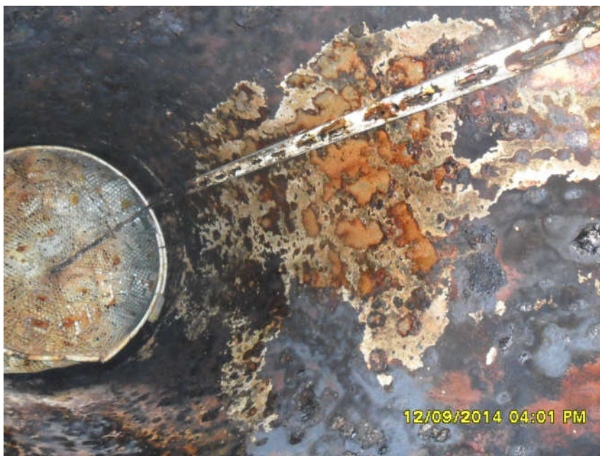
Figura 21 – Imagem ilustrando a corrosão interna coluna de purificação
