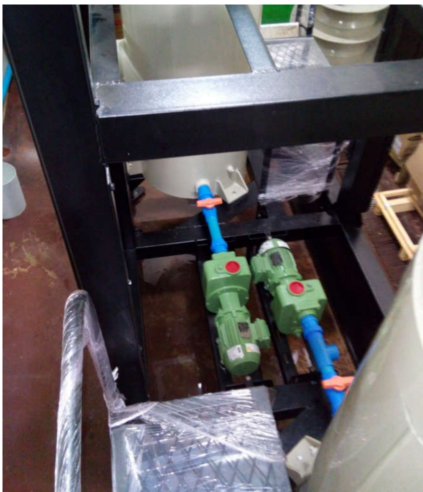
Figura 16 – Unidades de bombeamento do SPB3
