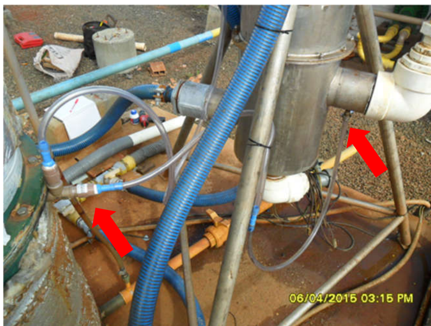
Figura 26 – Detalhe da parte inferior da coluna com adequação para drenagem de solução no borbulhador
