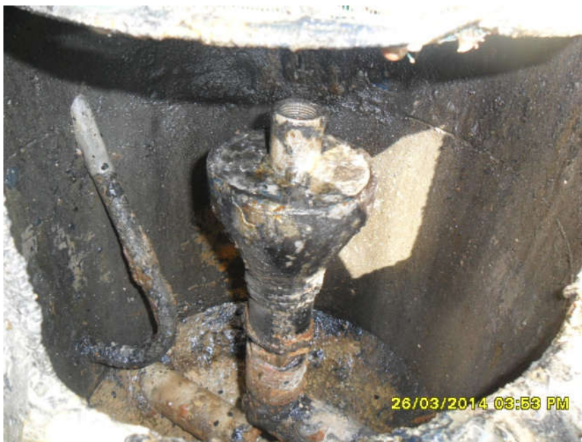
Figura 22 – Detalhe da corrosão no borbulhador
