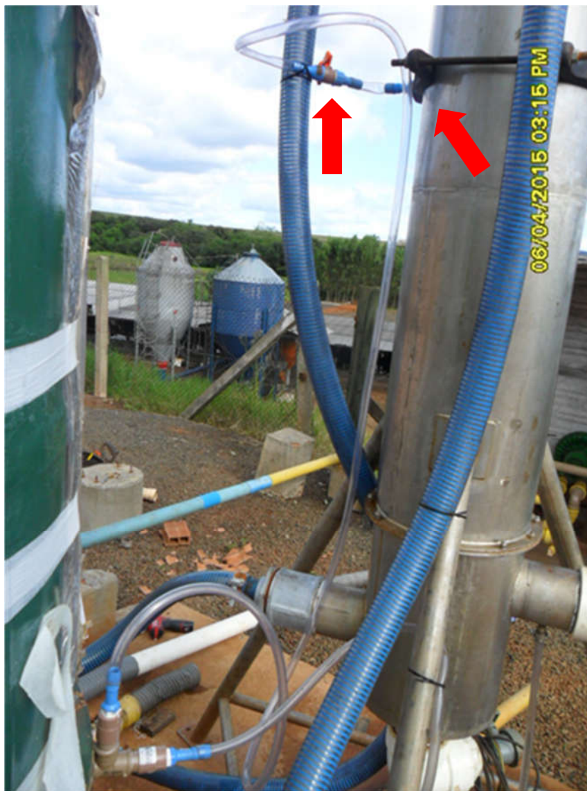
Figura 25 – Coluna de aço inox (coluna purificadora) e mangueira transparente para controle de altura para superfície de contato
