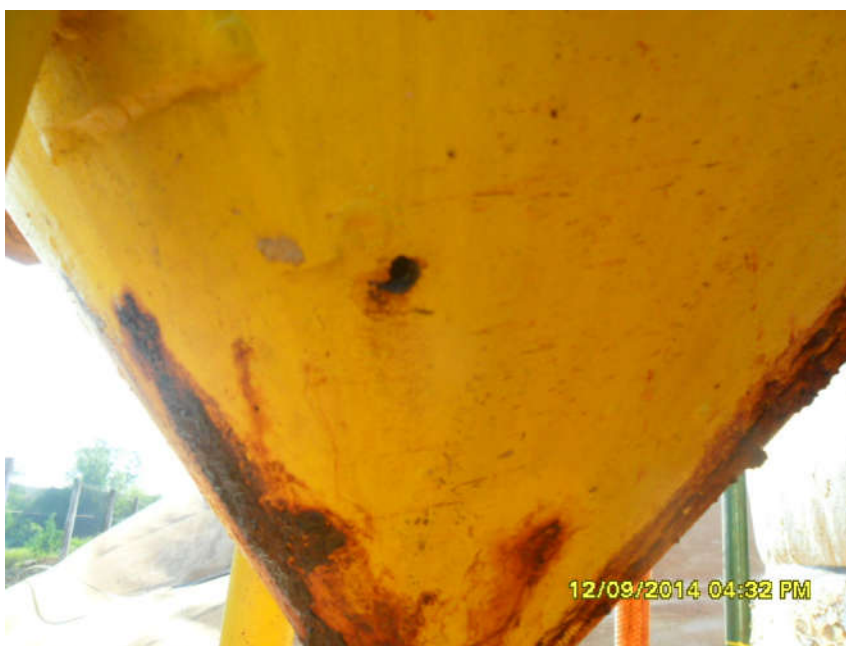
Figura 24 – Imagem ilustrando alguns pontos de corrosão e vazamento da coluna de purificação
