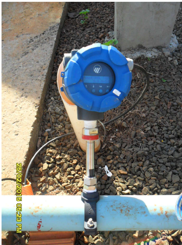
Figura 29 – Imagem do medidor de vazão disponível na linha de biogás conectada ao SPB2
