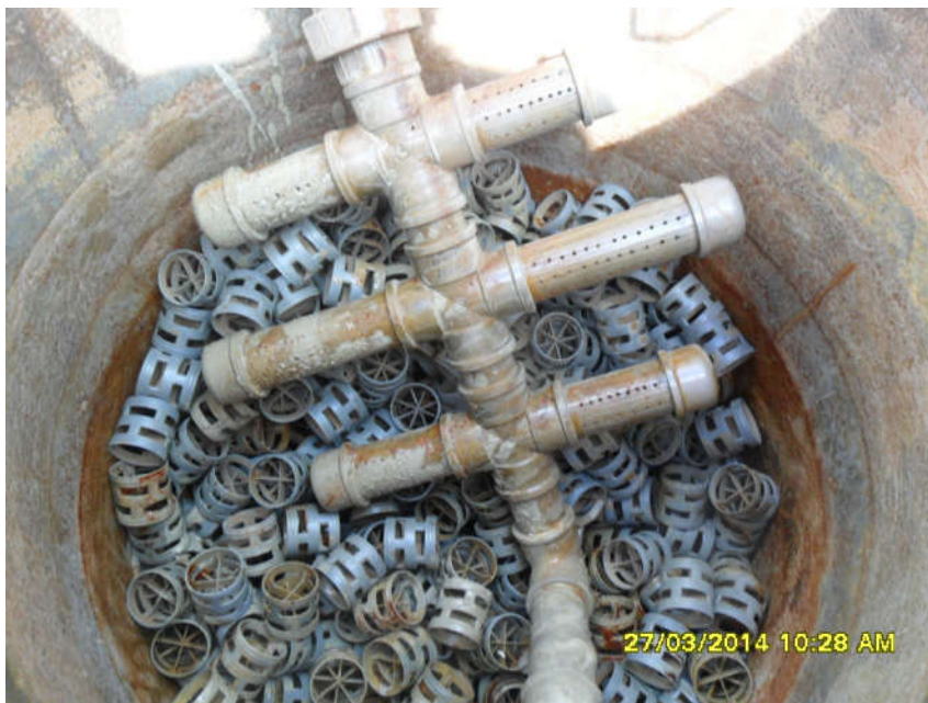
Figura 23 – Imagem detalhando a falha na fixação do borbulhador de ar atmosférico da coluna de regeneração
