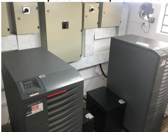
Figura 2 – Exemplo de nobreak para um Data Center
