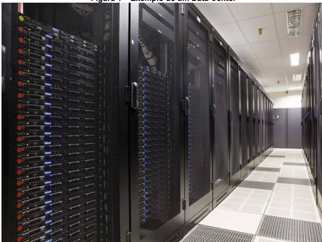
Figura 1 – Exemplo de um Data Center
