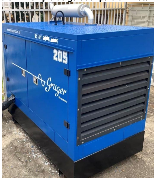
Figura 3 – Exemplo de gerador para um Data Center
