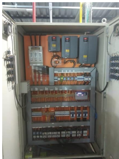
Figura 23 - Quadro do sistema de refrigeração.
