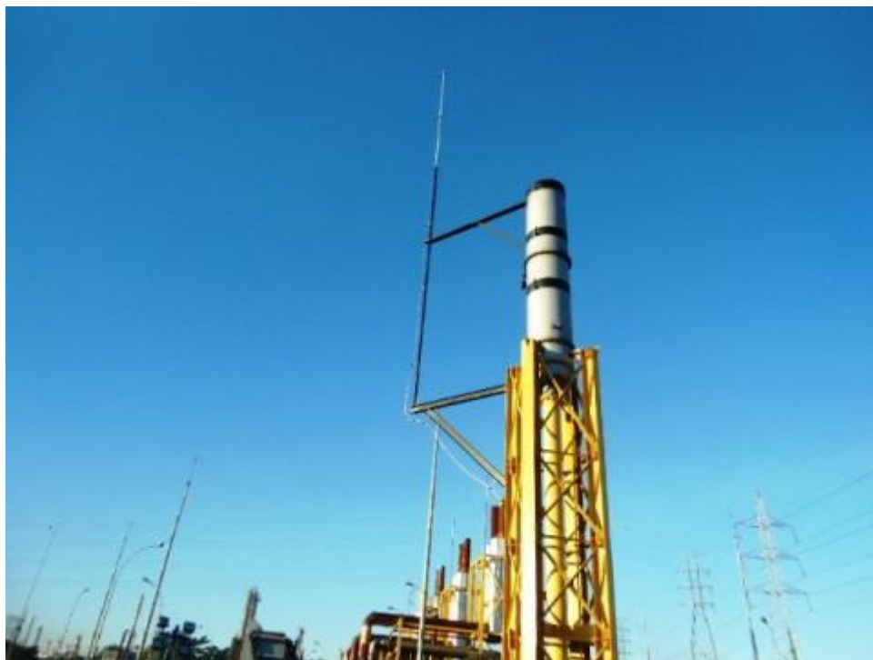
Figura 18- SPDA em uma torre de destilação de gás
