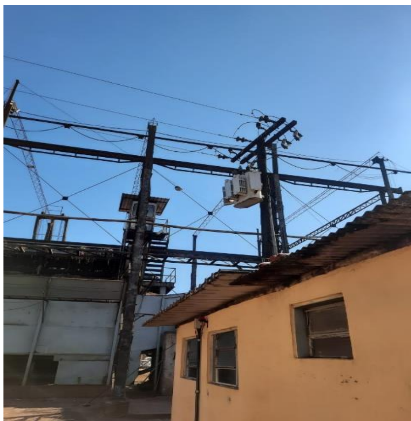
Figura 10 - Transformador de entrada da destilaria
