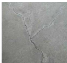
Figura 4: Fissuração do concreto.
