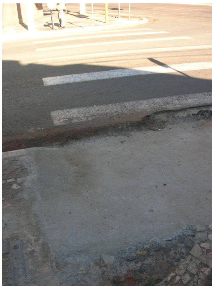
Figura 29 - Rampa sem demarcação e fora dos padrões (Fonte: foto do autor)
