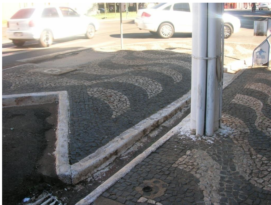
Figura 30 - Calçada e rampa fora das normas da ABNT NBR 9050:2004. (Fonte: foto do autor)
