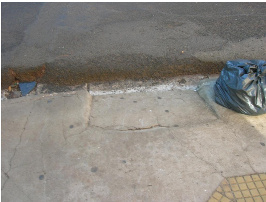
Figura 23 - Rampa com demarcação apagada e fora das medidas (Fonte: foto do autor)
