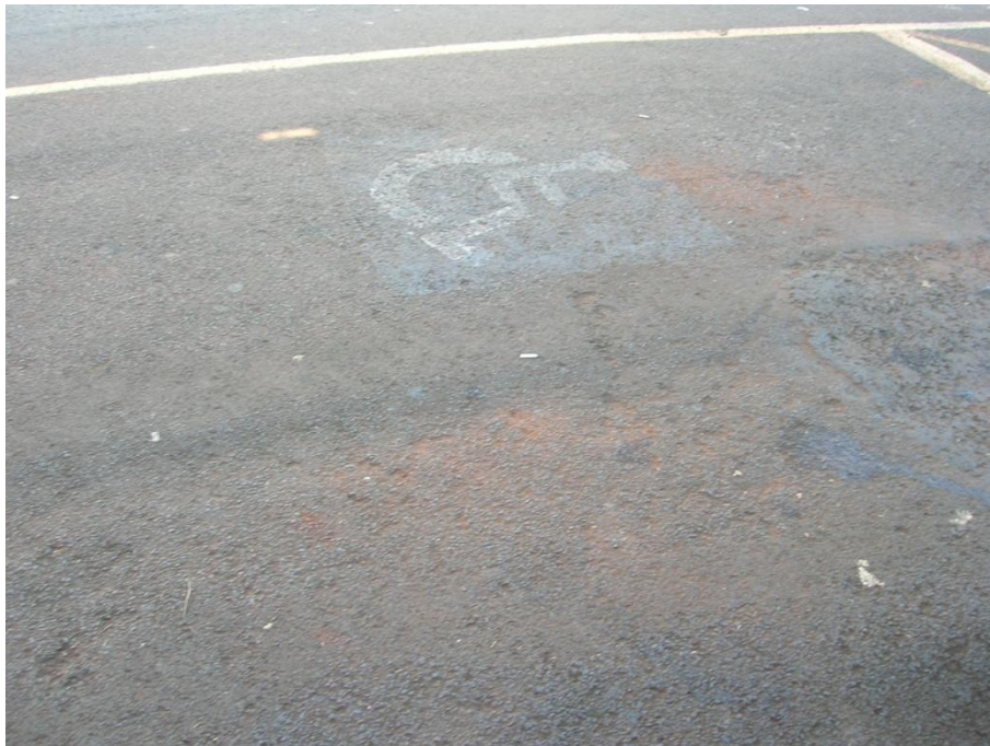
Figura 18- Demarcação apagada (Fonte: foto do autor)
