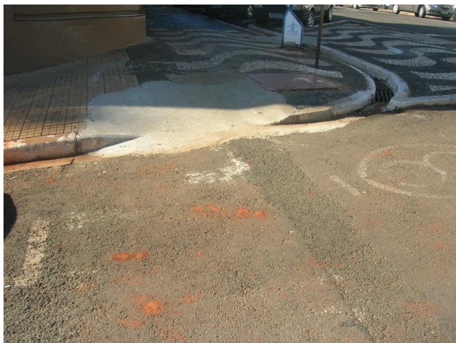
Figura 16 - Rampa sem demarcação na avenida principal (Fonte: foto do autor)
