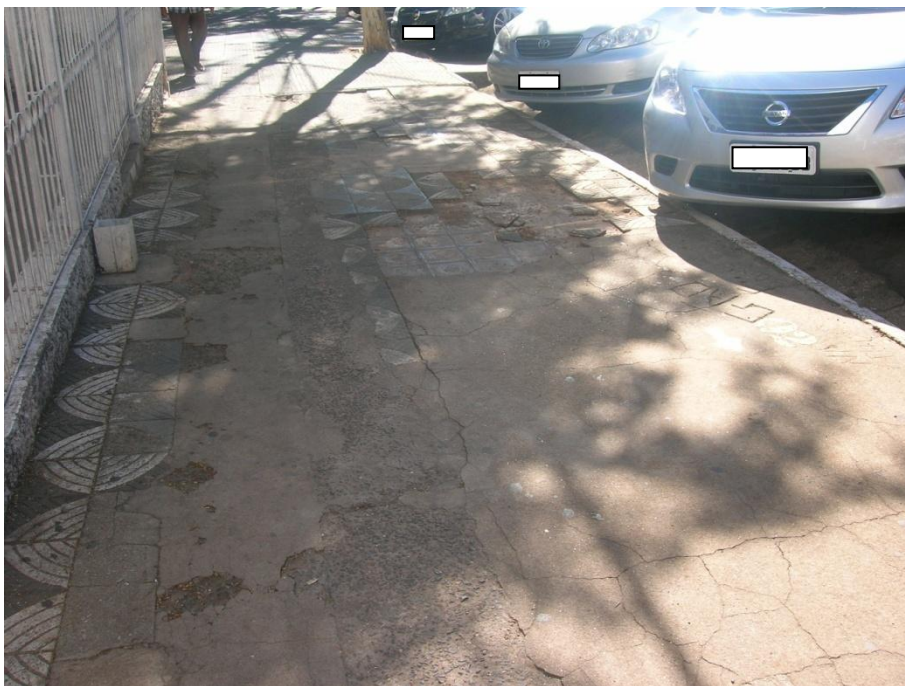
Figura 21 - Calçada danificada (Fonte: foto do autor)
