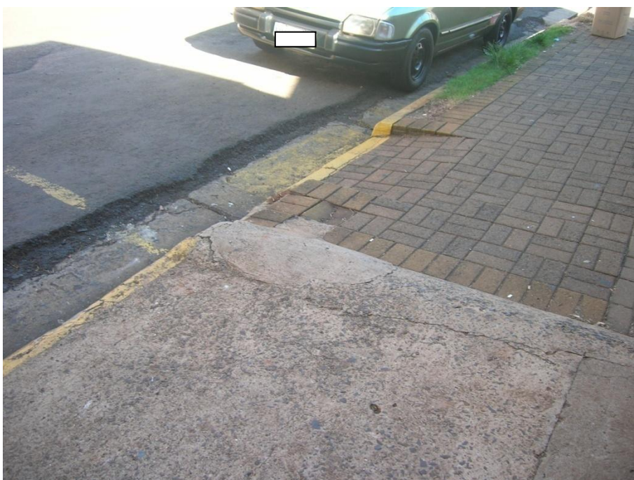
Figura 22 - Rampa com demarcação apagada e medida irregular (Fonte: foto do autor)
