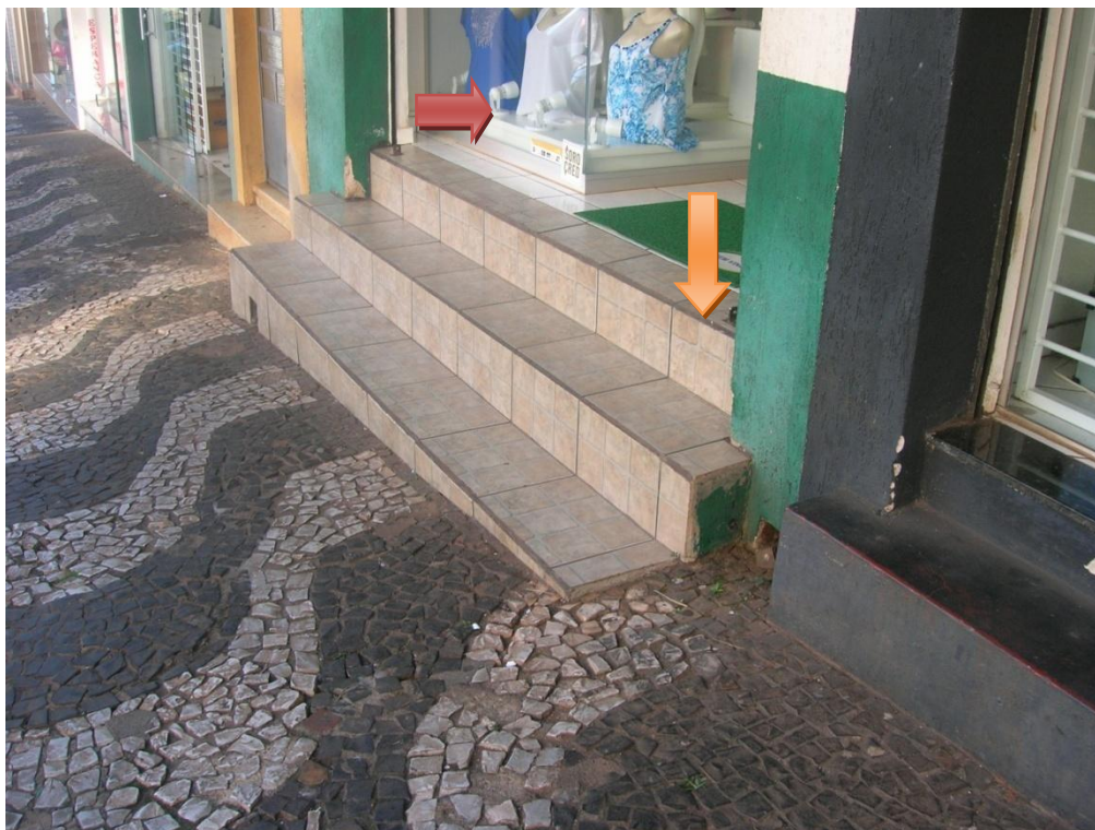
Figura 9- entrada loja 08(entrada irregular à acessibilidade) (Foto do autor)
