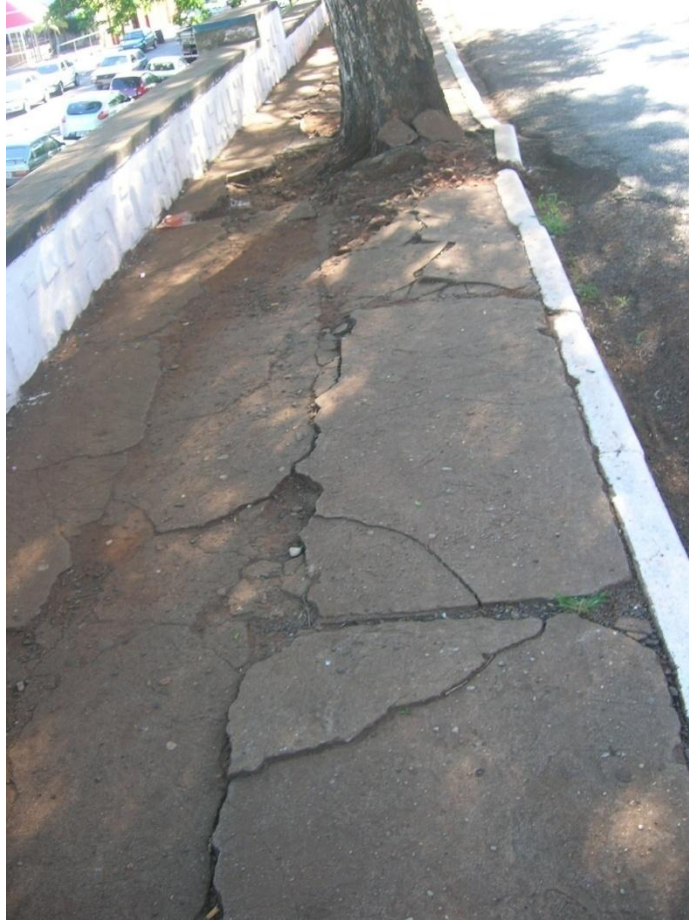
Figura 24 - Calçada totalmente danificada (Fonte: foto do autor)
