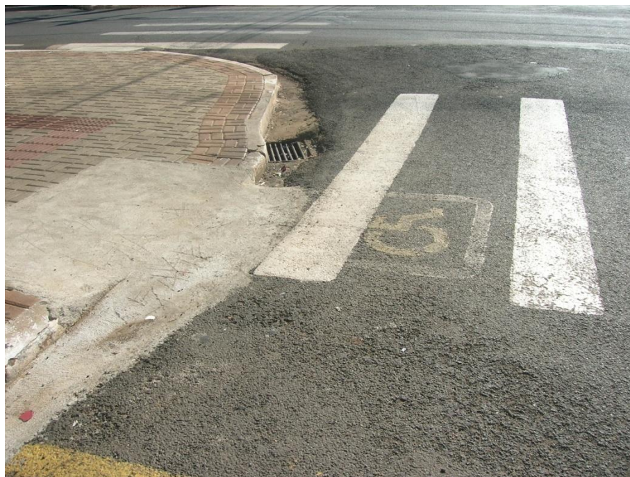
Figura 15 - Rampa sem demarcação na avenida principal (Fonte: foto do autor)
