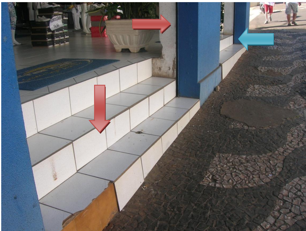
Figura 10 - entrada loja 09 (com irregularidades à acessibilidade) (Fonte: foto do autor)
