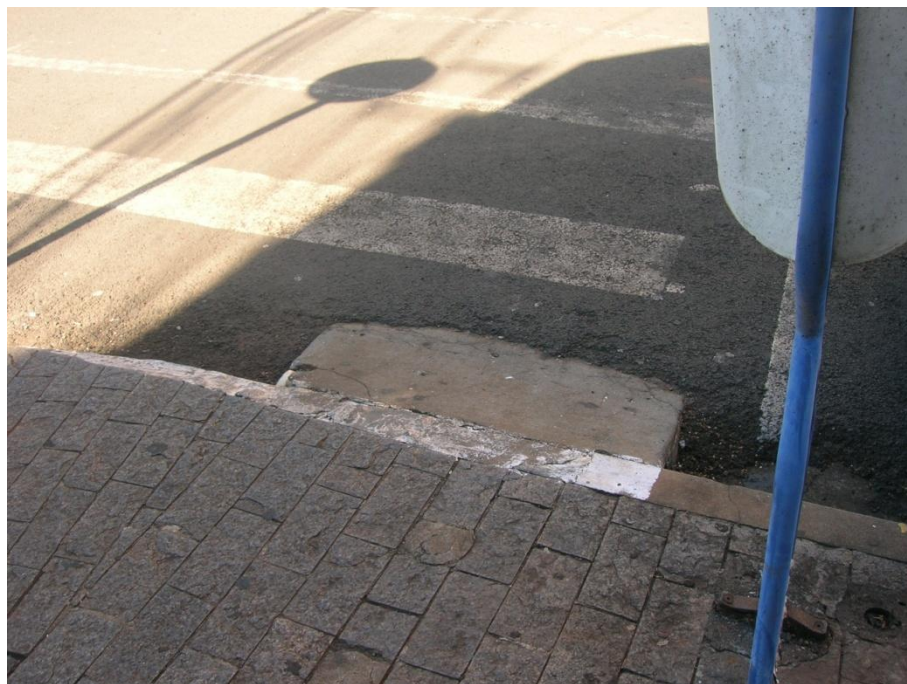
Figura 19 - Rampa sem demarcação (Fonte: foto do autor)
