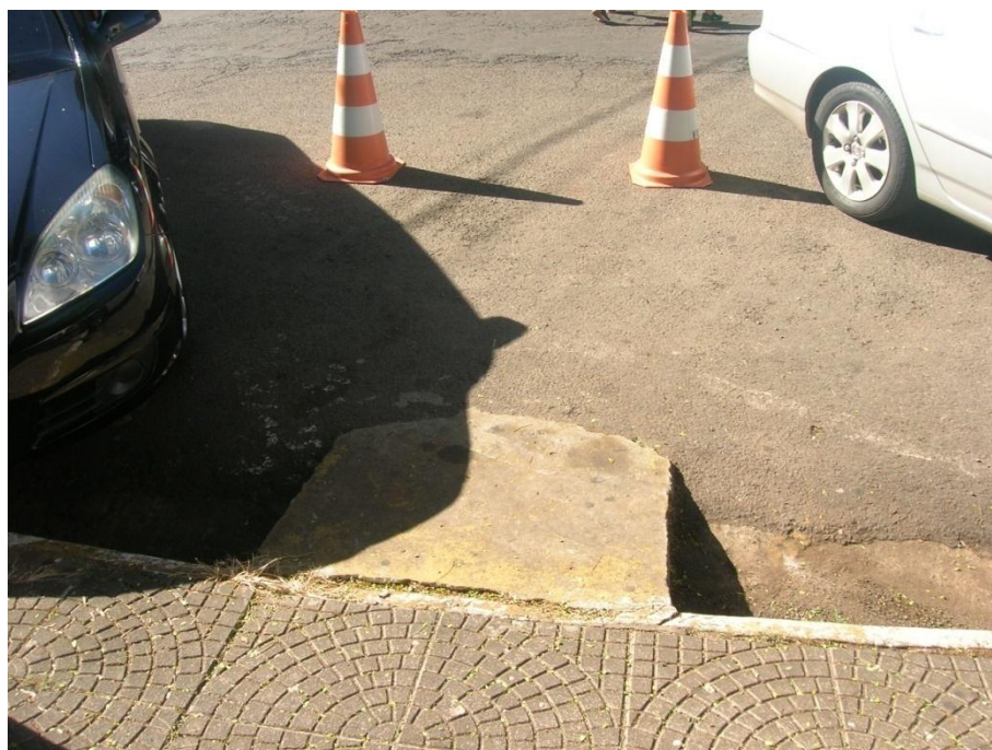
Figura 20 - Rampa sem demarcação e medida irregular (Fonte: foto do autor)
