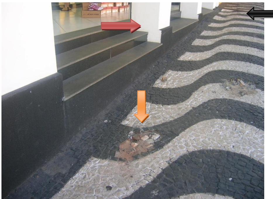
Figura 6 - entrada loja 05(difícil acesso e calçada danificada) (Fonte: foto do autor)
