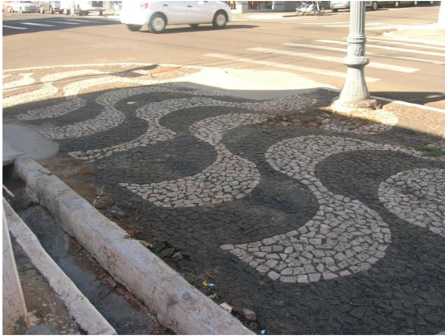
Figura 17 - Rampas sem demarcação na avenida e calçada danificada (Fonte: foto do autor)
