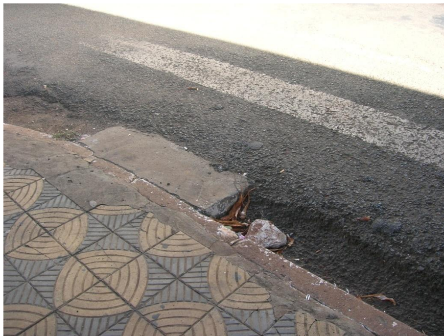
Figura 25 - Rampa sem demarcação e medida irregular (Fonte: foto do autor)
