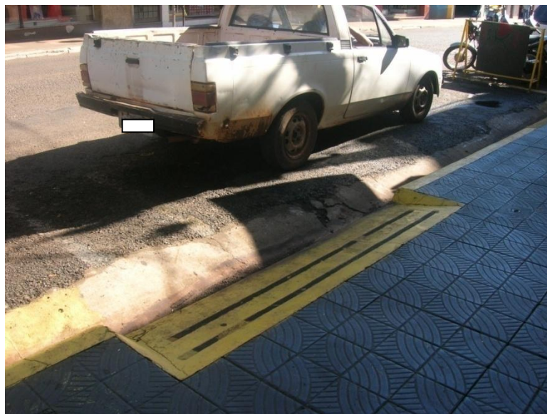
Figura 28 - Rampa fora das medidas, com declive acentuado (Fonte: foto do autor)
