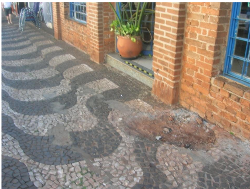
Figura 14 - Calçada danificada (barzinho conceituado na cidade) (Fonte: foto do autor)
