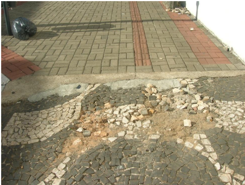
Figura 13 - Calçada da avenida principal com buracos (Fonte: foto do autor)
