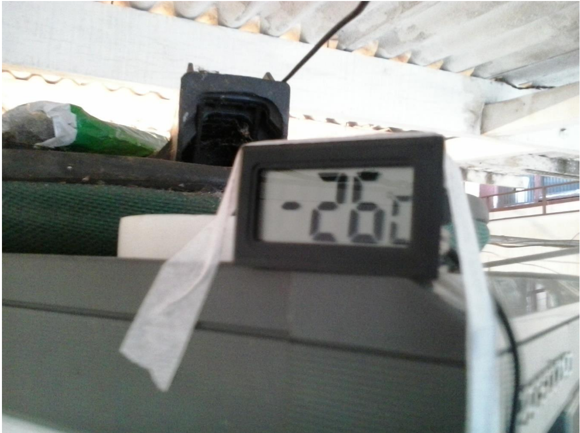
Figura 12 - Termômetro indicando a temperatura do evaporador.
