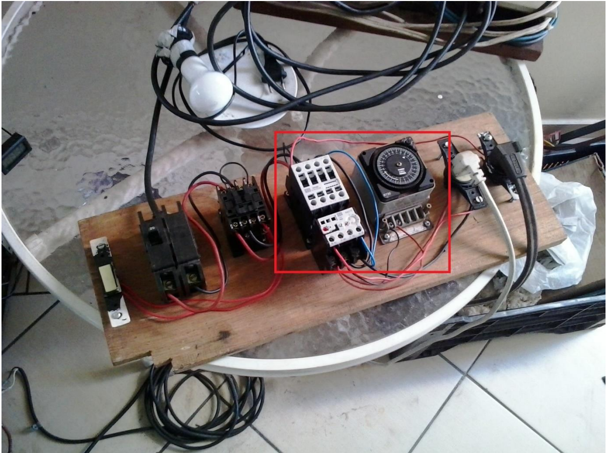
Figura 14 - Controle elétrico, em evidencia o horímetro e seu contator.
