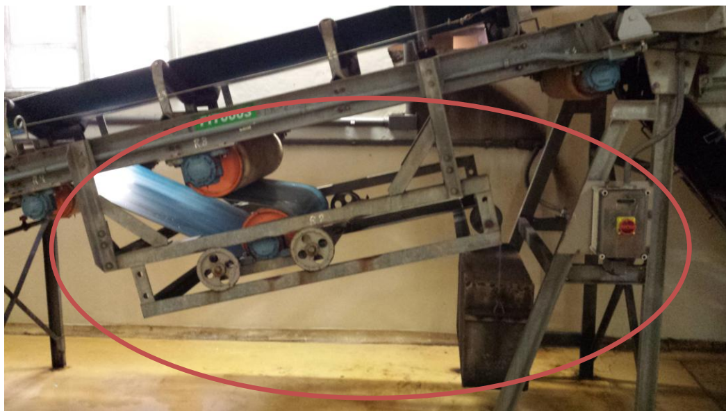
Figura 25 - Sistema de tensionamento de fitas transportadoras. FONTE: ACERVO PRÓPRIO
