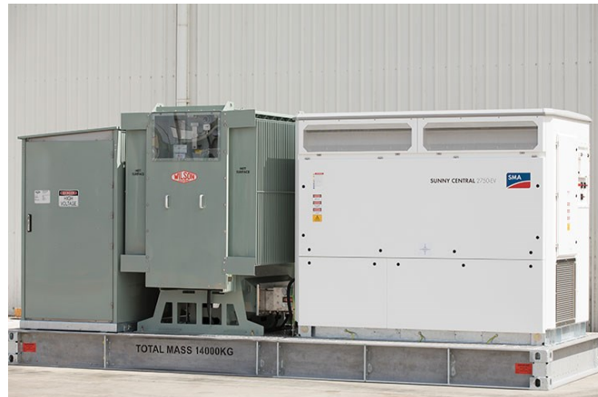
Figura 8 - SKID solar com 1 inversor
