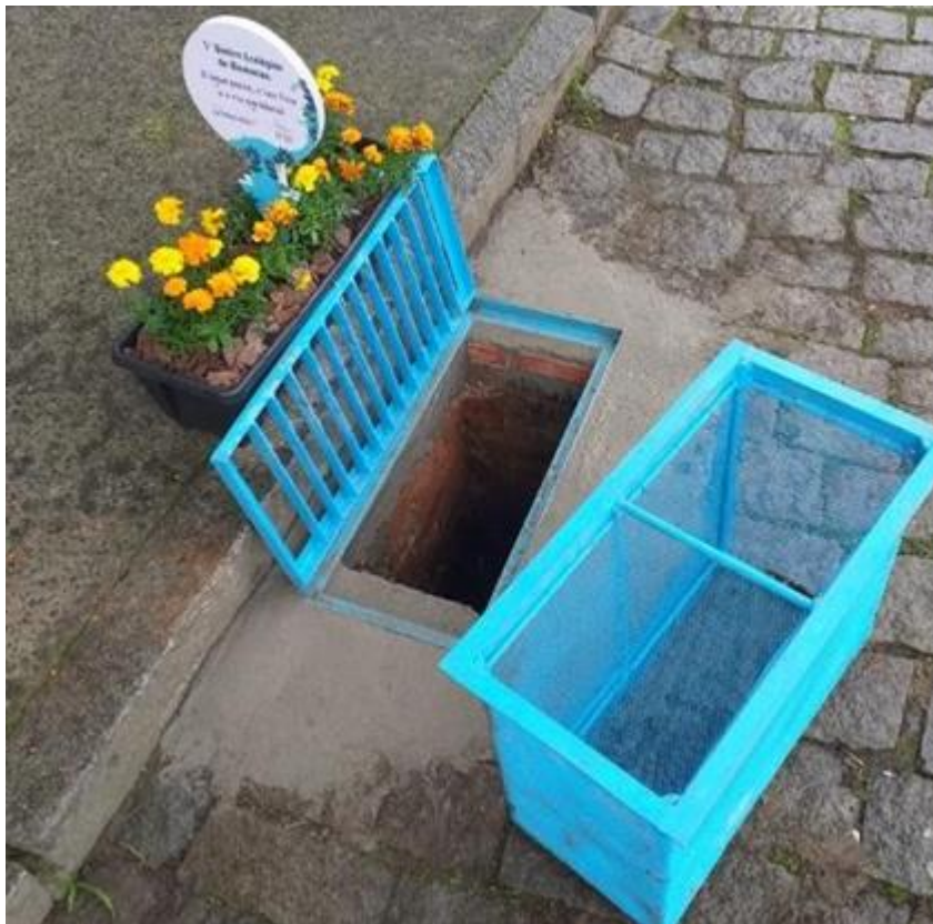
Figura 16. Boca de Lobo Azul, instalado em Blumenau – SC.
