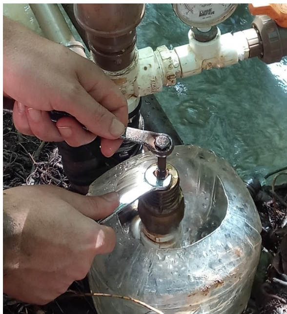
Figura 26 – Detalhe da regulação da válvula de impulso
