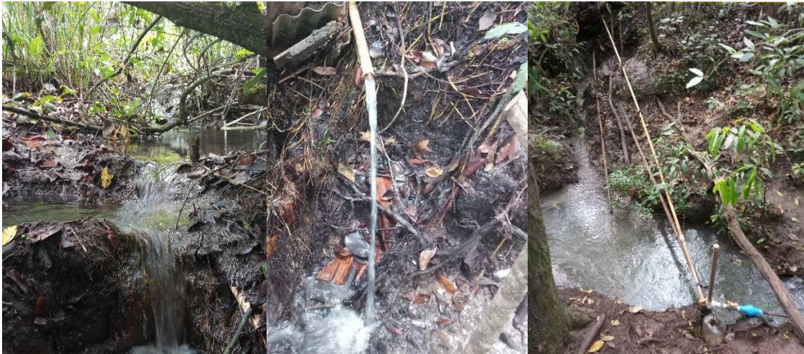
Figura 18 – Detalhe local da fonte, mina d'água (esquerda), início da tubulação de alimentação (centro), CH instalado (direita)
