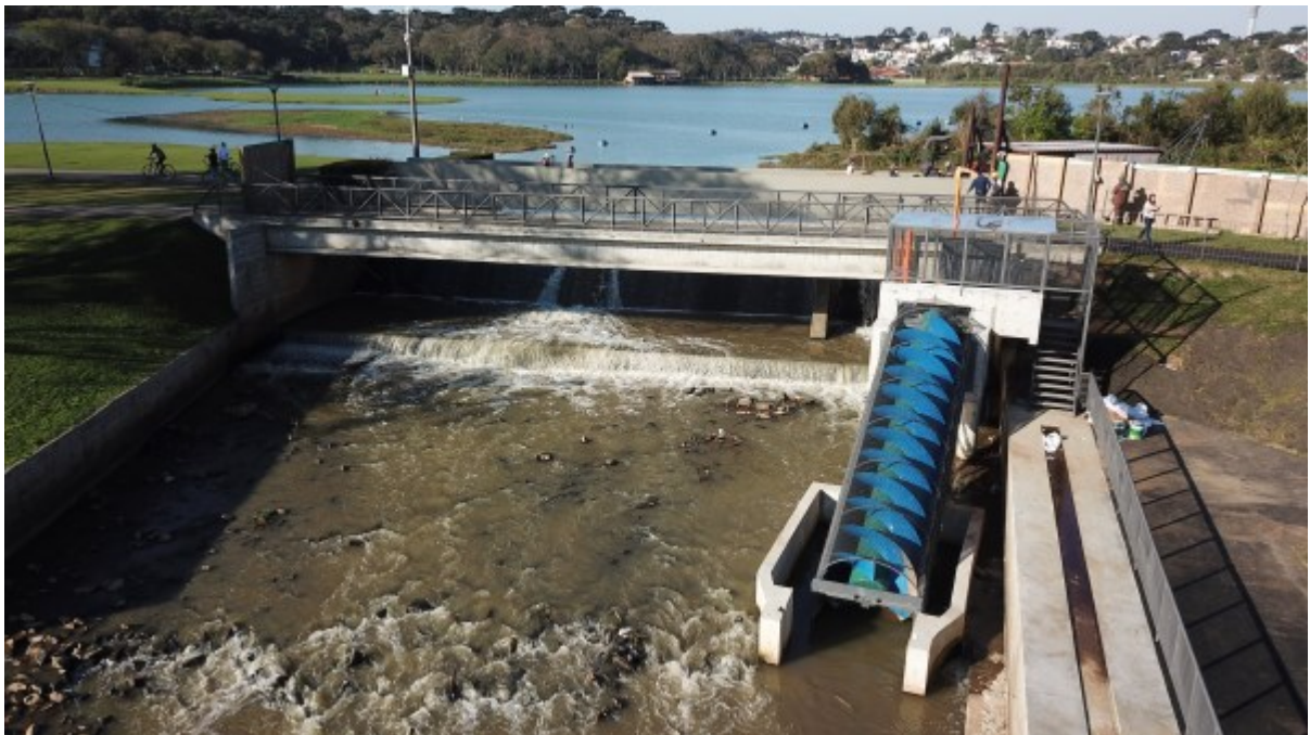
Figura 6: Micro Central Hidrelétrica construída no parque Barigui. Fonte: Bem Paraná
