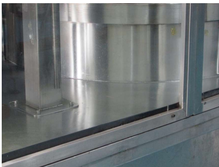
Figura 10 – Vedação de borracha instalada na porta da enchadeira
