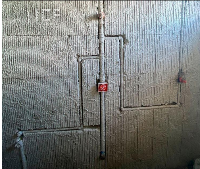
Figura 7 - Instalações Hidráulicas embutidas Fonte: ICF Construtora Inteligente (2021)
