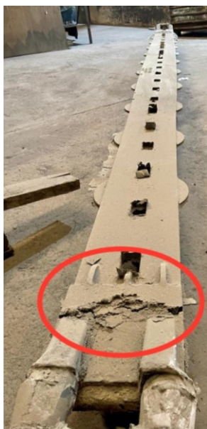
Figura 25 – Suporte de tubos utilizado em fornos petroquímicos apresentando trincas
