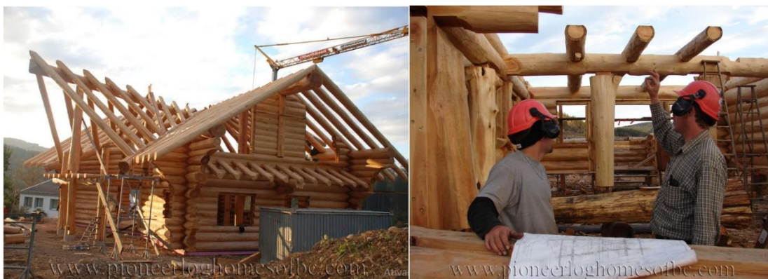
Figura 6: Exemplo de uma log home em construção Fonte: Pioneer Log Homes of B.C. (2019).
