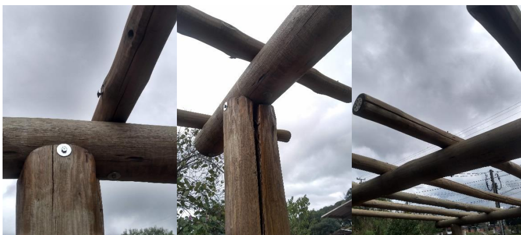
Figura 26: Detalhes das ligações e retrações transversais do pórtico espacial em madeira roliça Fonte: Autoria própria (2019).
