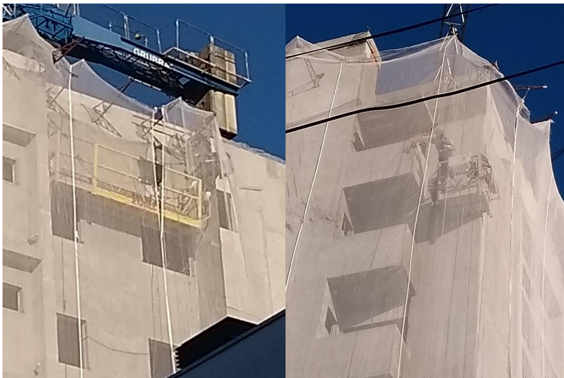
Figura 2: Trabalhadores cometendo ato inseguro executando trabalhos fora do balancim. Fonte: Autoria Própria
