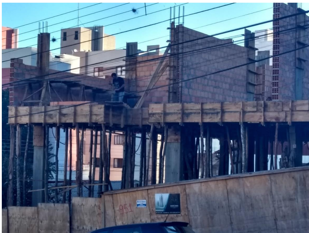
Figura 3: Ausência de EPIs e EPCs para trabalho em altura.
