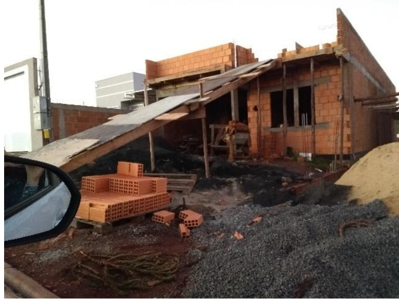
Figura 10: Rampa inadequada. Fonte: Autoria Própria
