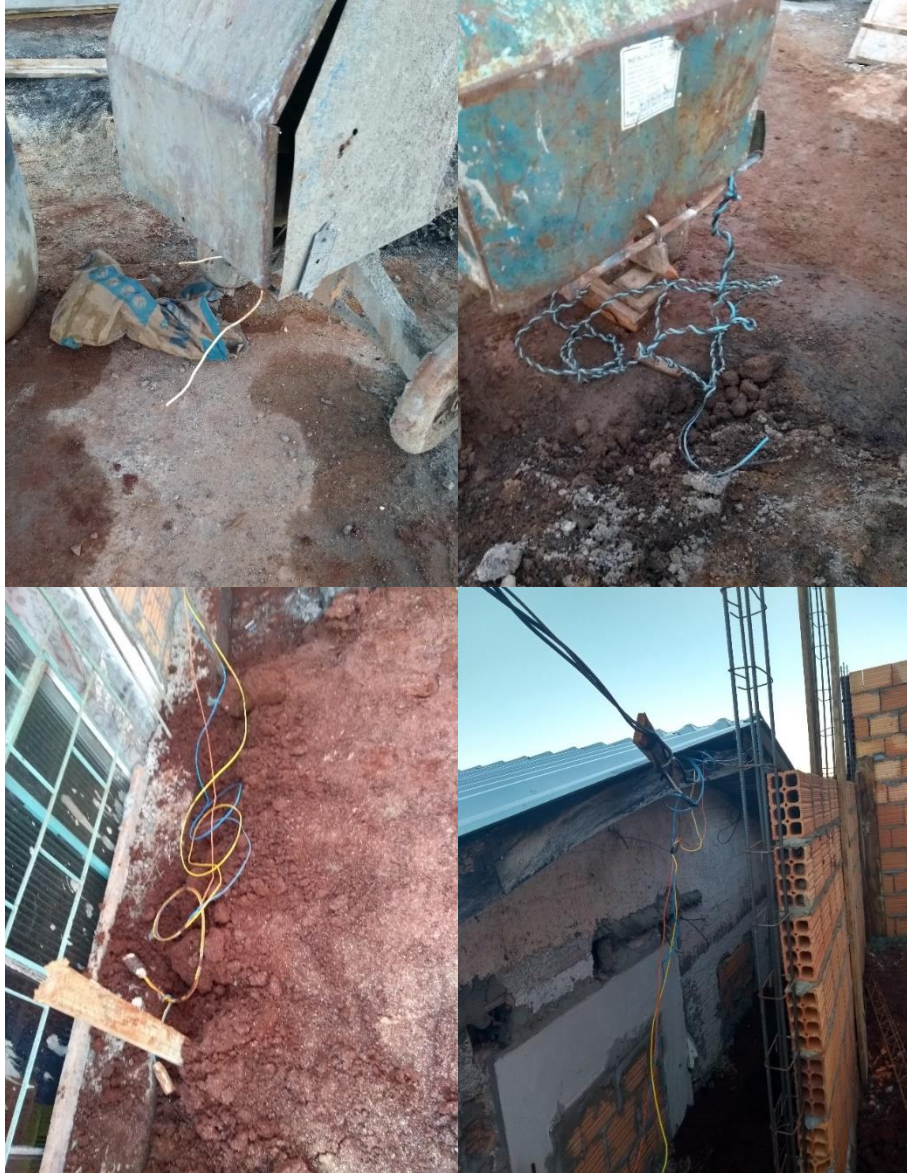
Figura 9: Risco elétrico. Fonte: Autoria Própria
