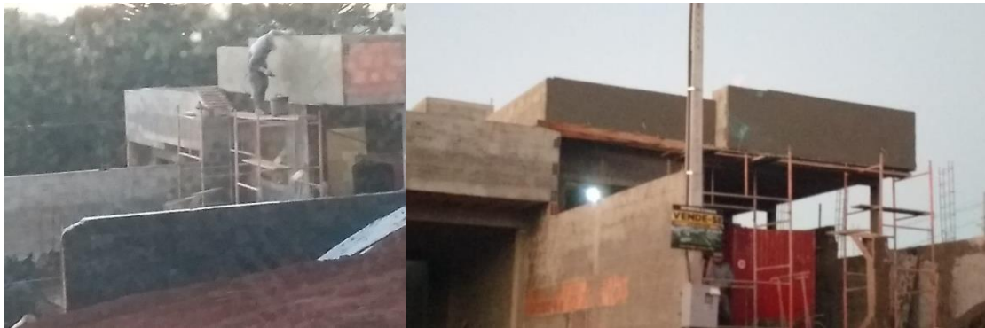
Figura 11: Escada sendo utilizada como andaime. Fonte: Autoria Própria
