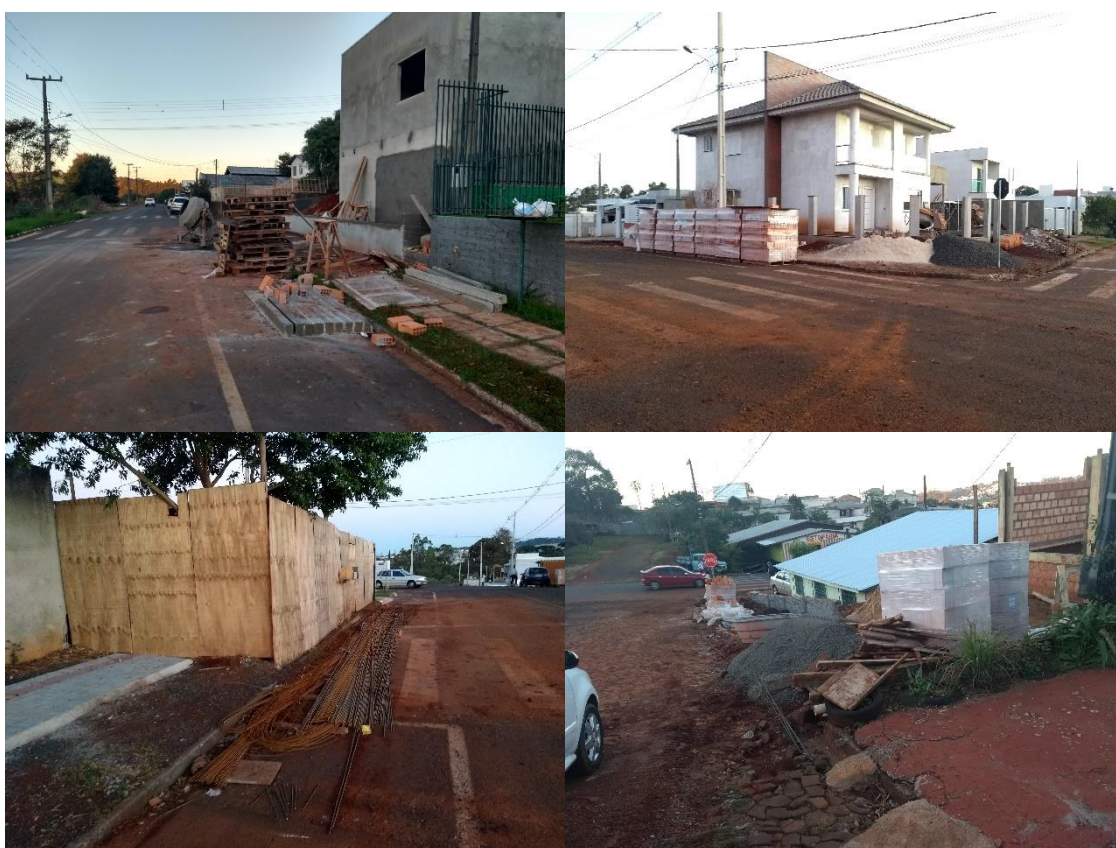
Figura 8: Descumprimento dos limites do canteiro em diversas obras da cidade de Pato Branco. Fonte: Autoria Própria
