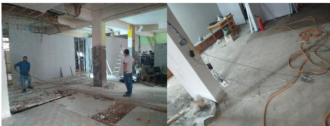
Figura 7: Reforma com várias irregularidades. Fonte: Autoria Própria
