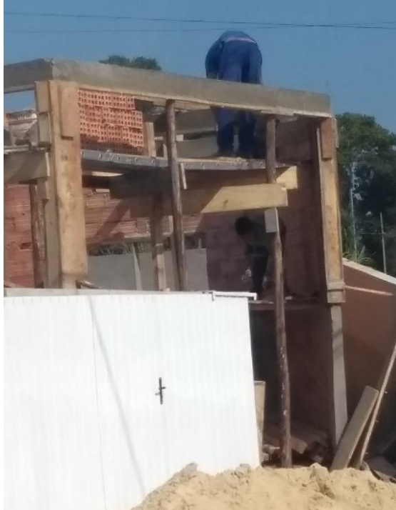
Figura 12: Presença de pessoa menor de idade no canteiro. Fonte: Autoria Própria.
