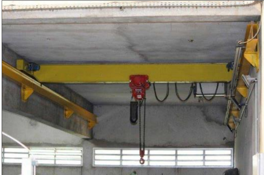
Figura 1 - Ponte Rolante Apoiada Univiga.
