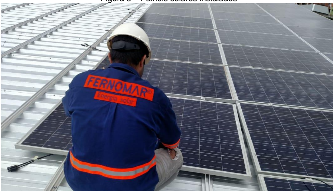
Figura 5 – Painéis solares instalados
