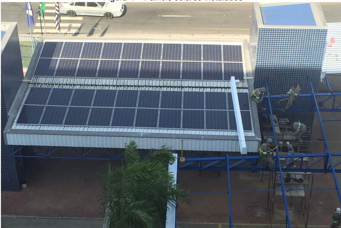
Figura 4 – Painéis solares instalados
