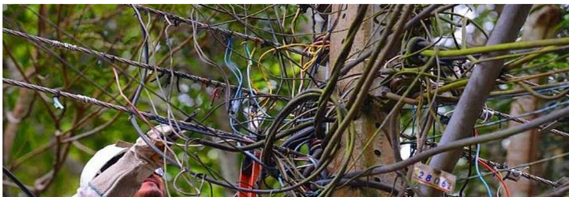
Figura 1 - Desvios de energia em Baixa Tensão
