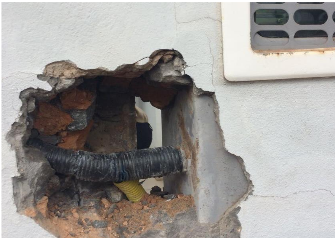
Figura 2 - Desvio de energia no ramal de entrada do medidor
