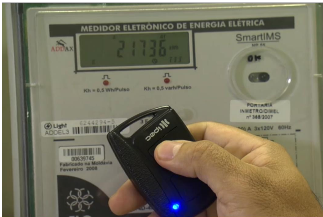
Figura 3 - Dispositivo eletrônico utilizado para 'gato', empregado dentro do medidor, ativado via controle remoto
