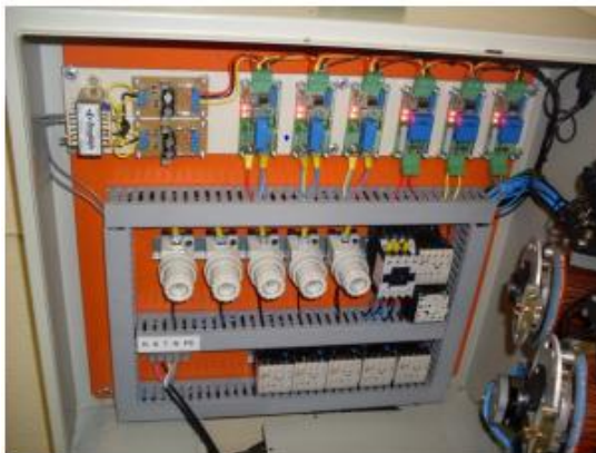
Figura 5: Sensores Hall de corrente e Tensão
