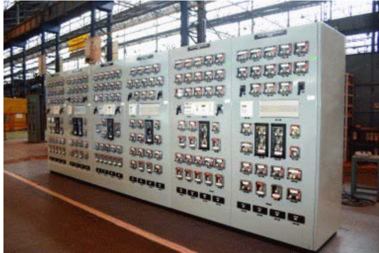
Figura 4: Painel de relé
