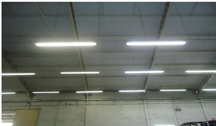
Figura 14: Lâmpadas LED já instaladas e energizadas no primeiro galpão do grupo Fonte: Empresa estudada no norte do Paraná
