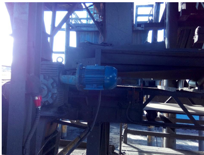
Figura 22 - Correia transportadora 4 com motor pós troca
