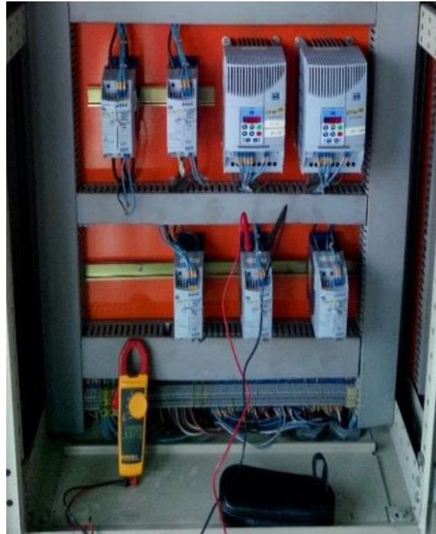
Figura 15 – Medição de tensão no CCM. Fonte: autoria própria
