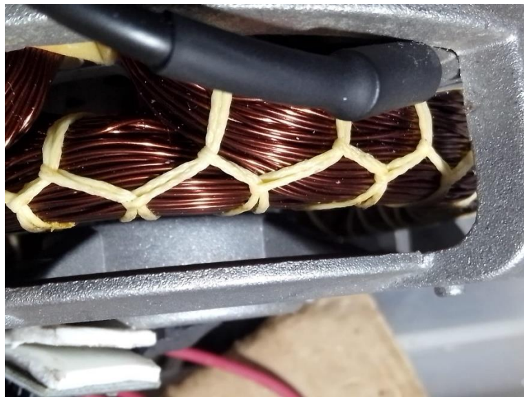
Figura 18- Sensor de temperatura posicionado nas bobinas do estator. Fonte: Autoria própria.
