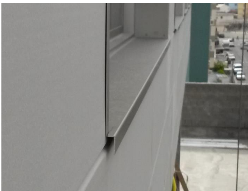
Fotografia 11 - Acabamento entre esquadria e revestimento externo
