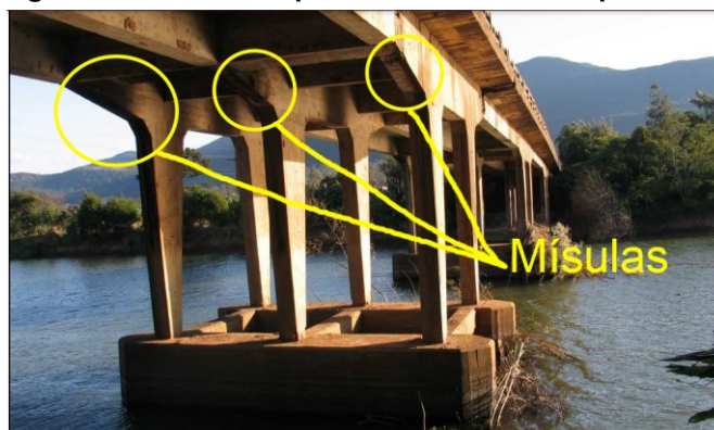
Figura 9 - Mísulas na ponte sobre o Rio Maquiné - RS
