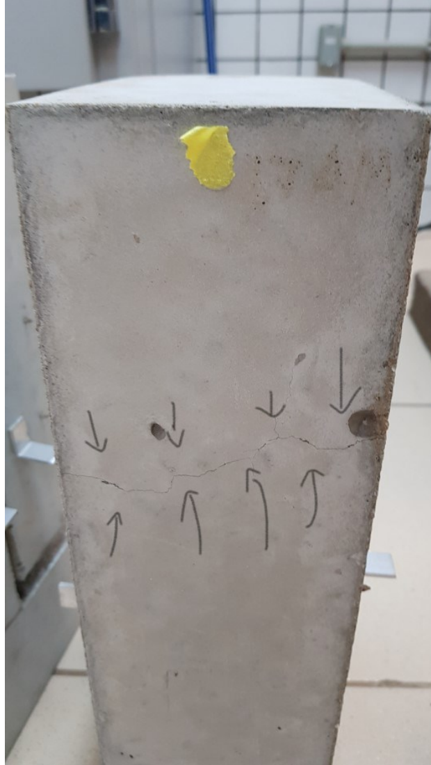
Figura 15 - Fissura causada pela flexão da aba superior.
