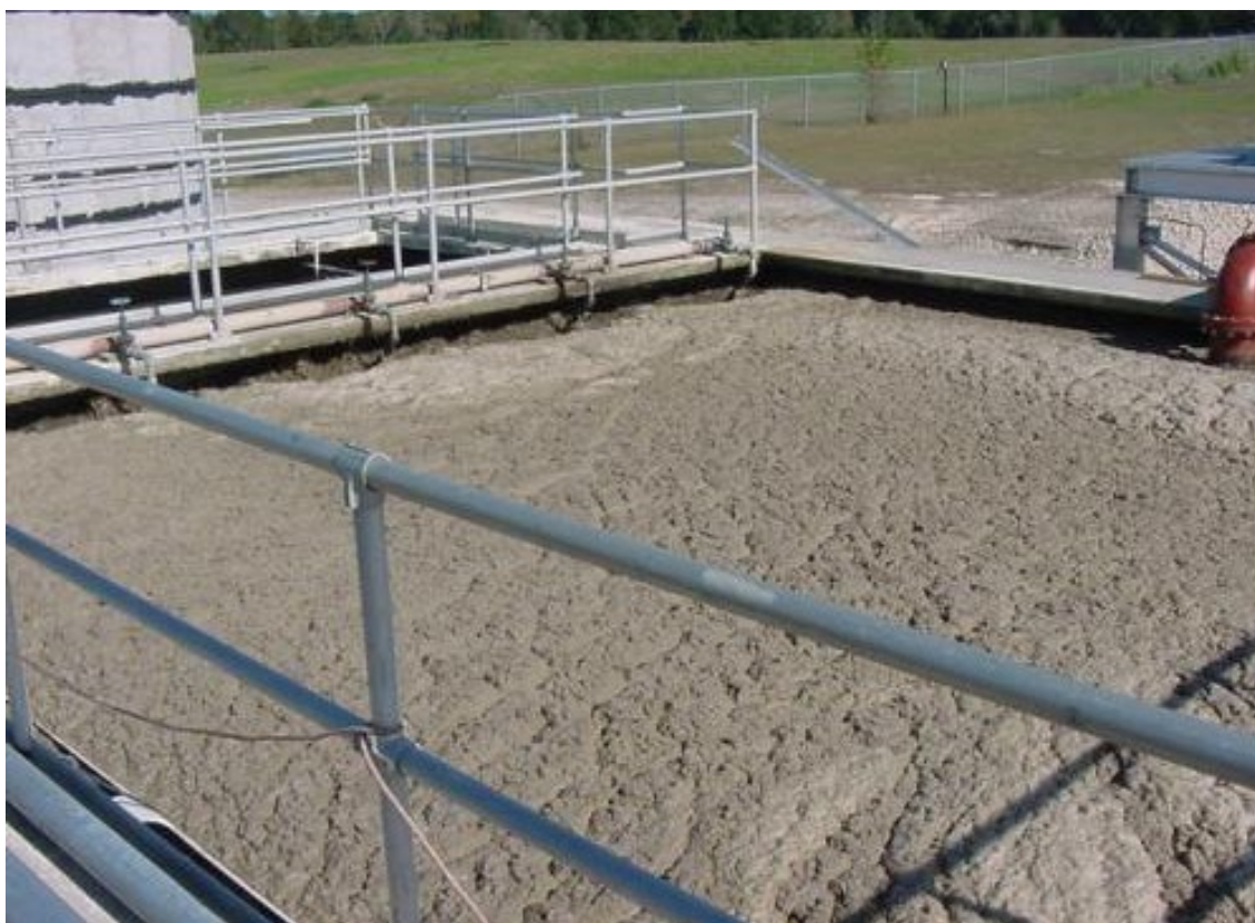
Figura 2 - Espuma em estação de tratamento de esgoto
