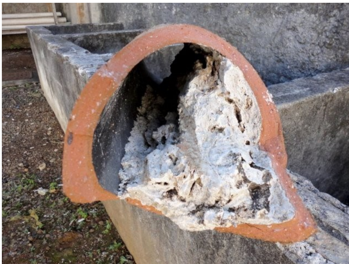
Figura 1 - Coletor obstruído por gordura
