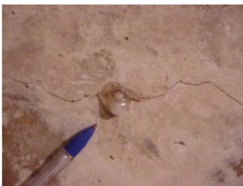
Figura 3. Detalhe do gel exsudado através da fissura na superfície do concreto. Fonte: HASPARYK (2005).
