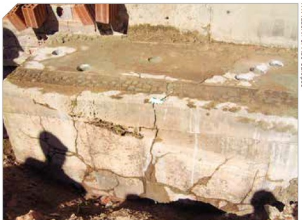
Figura 1. Bloco de fundação de edifício em Recife afetado por RAA, Fonte: PECCHIO, 2016.
