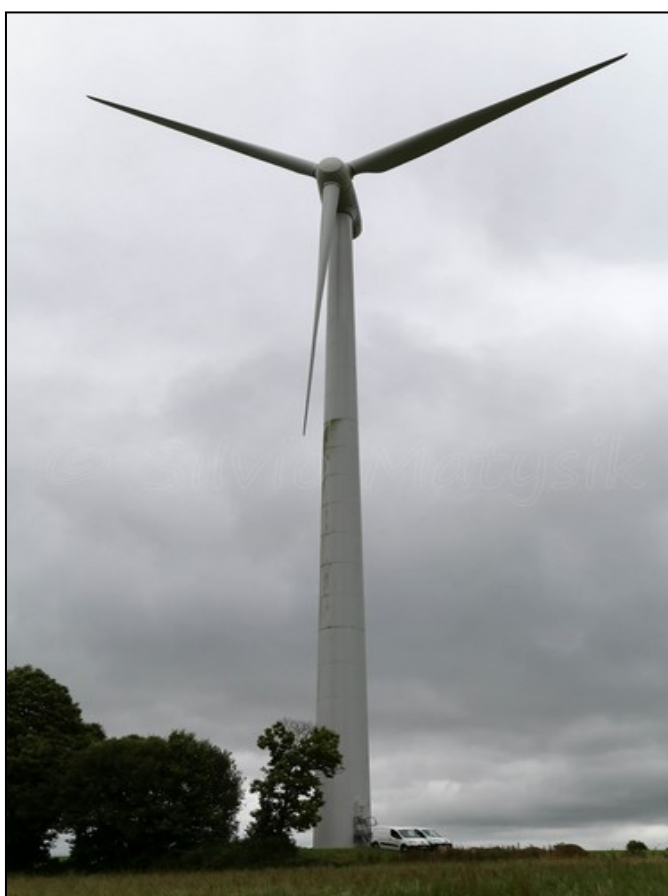
Figura 37: Turbina eólica WinWinD WWD-1 D56
