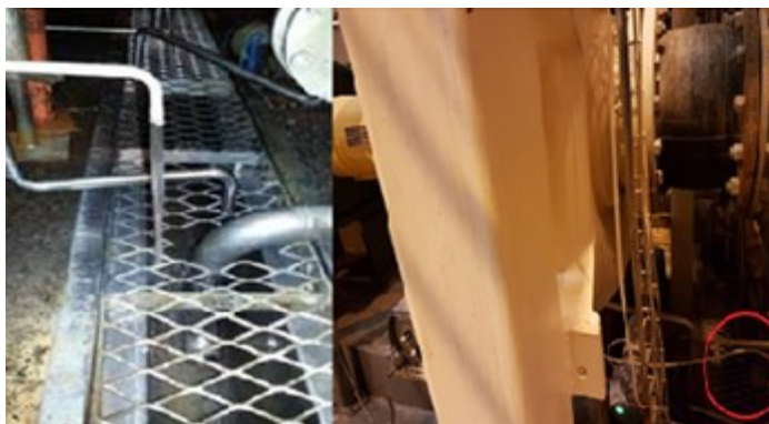
Figura 8 – Água de refrigeração do selo da bomba Sulzer antes e depois dos reaproveitamentos Fonte: Empresa
