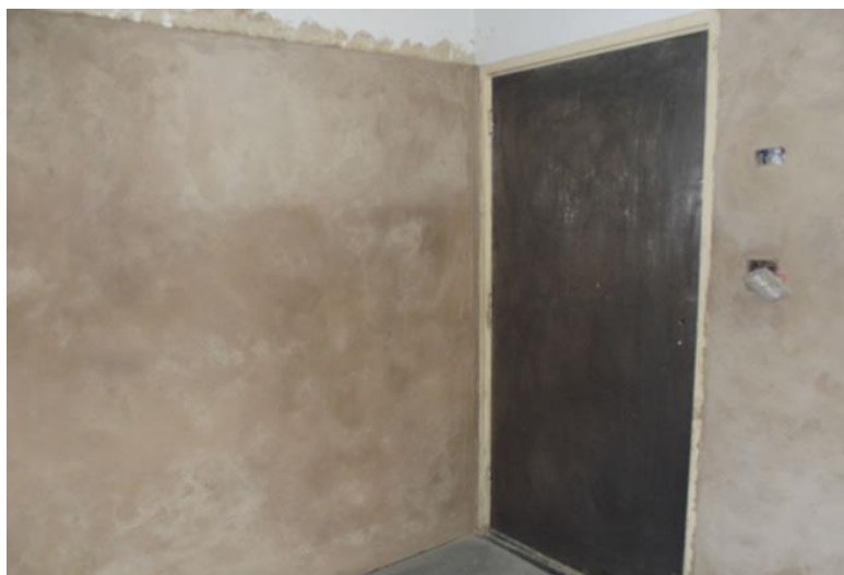
Figura 2 - Barreira de proteção radiológica com argamassa baritada
