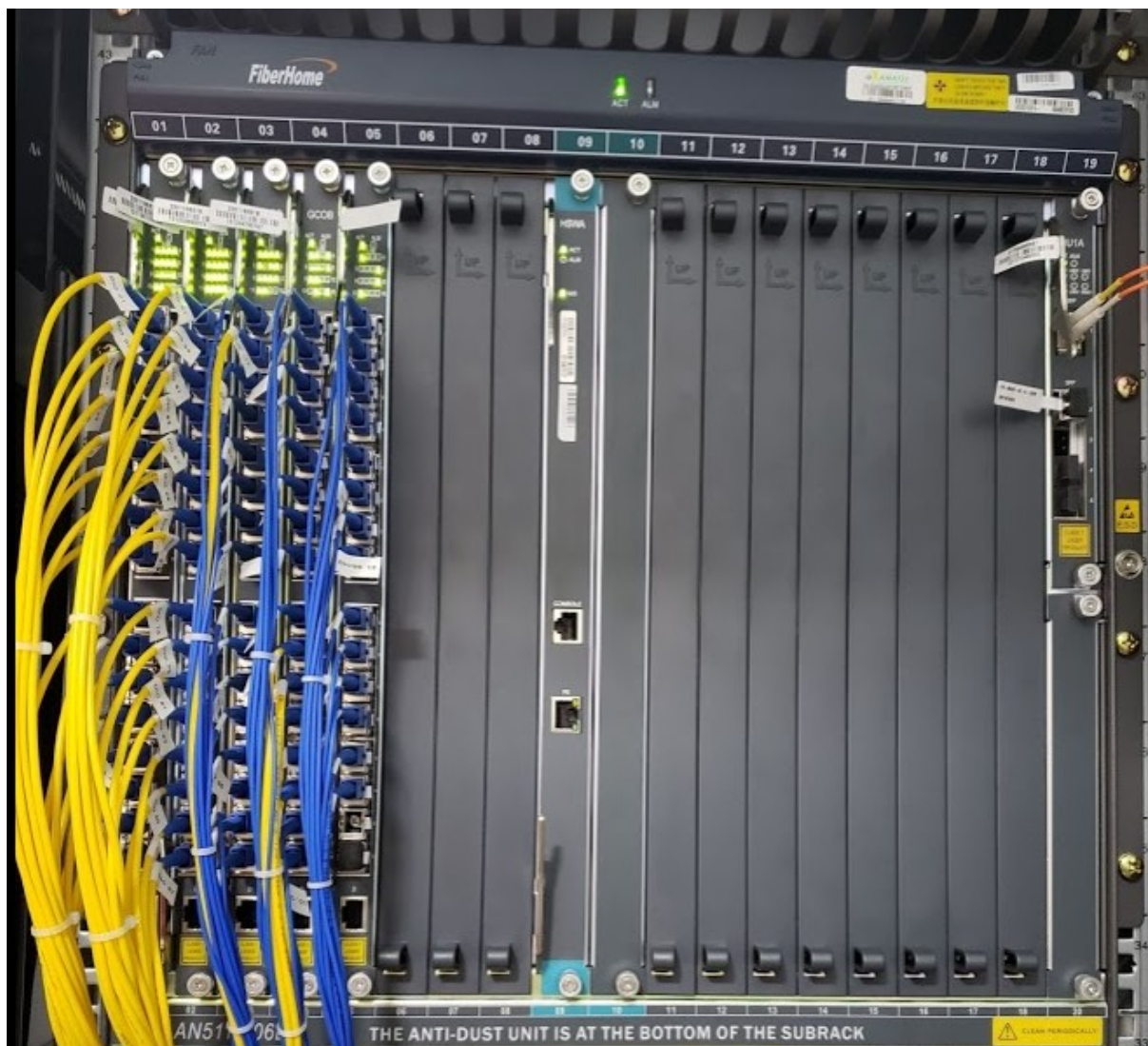
Figura 11: Equipamento Óptico OLT Fonte: Autoria Própria.
