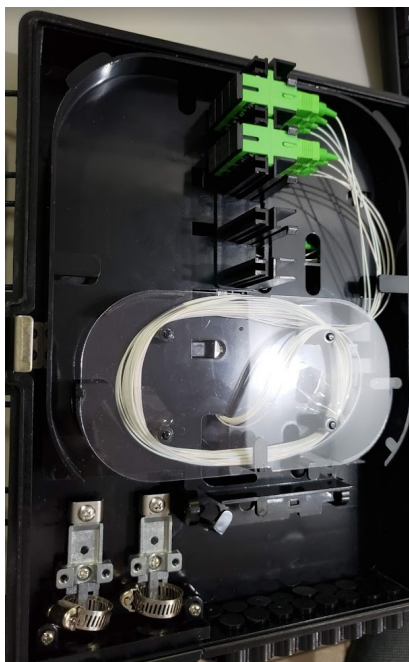
Figura 2021: Caixa de Atendimento Fonte: Aatoria Própria
