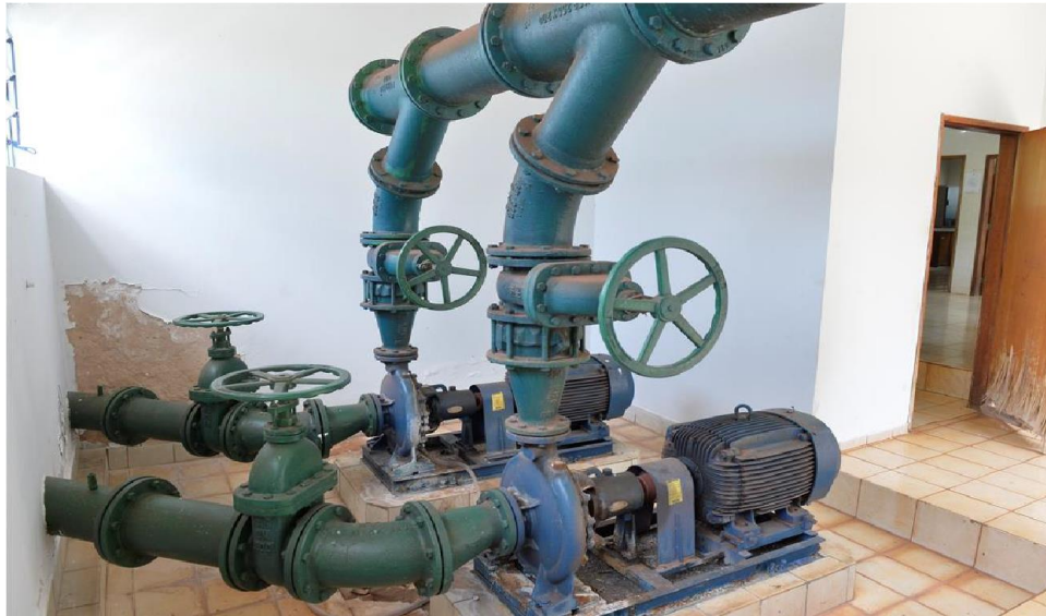
Figura 10 – Conjuntos motor bomba da elevatória de água tratada 1 (EAT 1).
