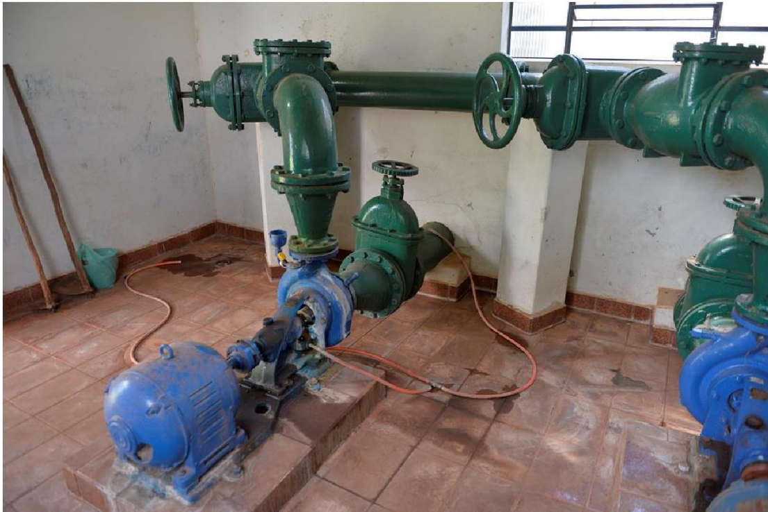
Figura 15 – Conjuntos motor bomba da elevatória de água tratada 2 (EAT 2).
