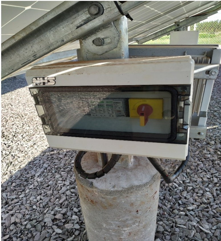
Figura 5 – String Box da Estação Solarimétrica da UTFPR
