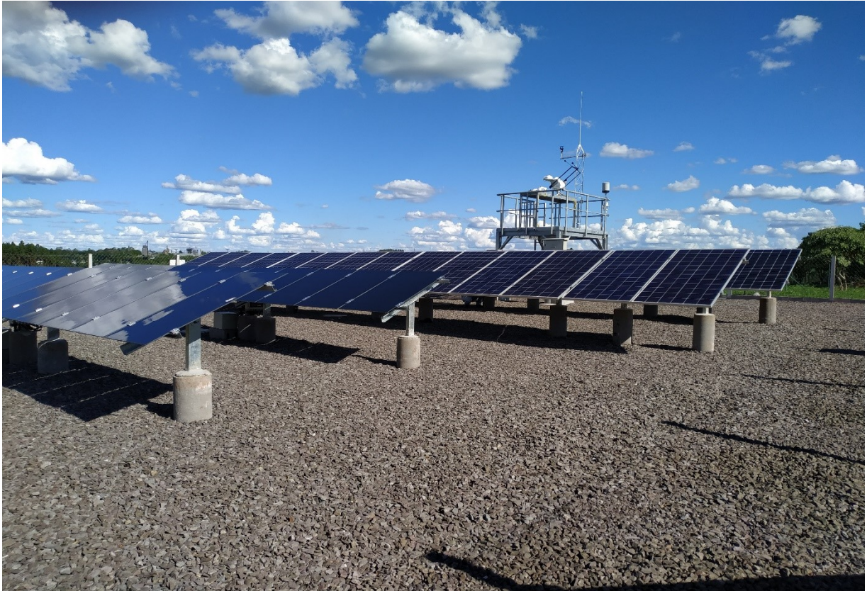
Figura 10 – Estação Solarimétrica da UTFPR
