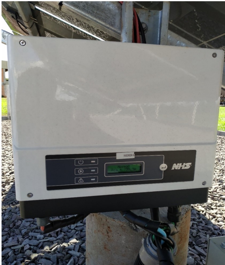
Figura 4 – Inversor da Estação Solarimétrica da UTFPR
