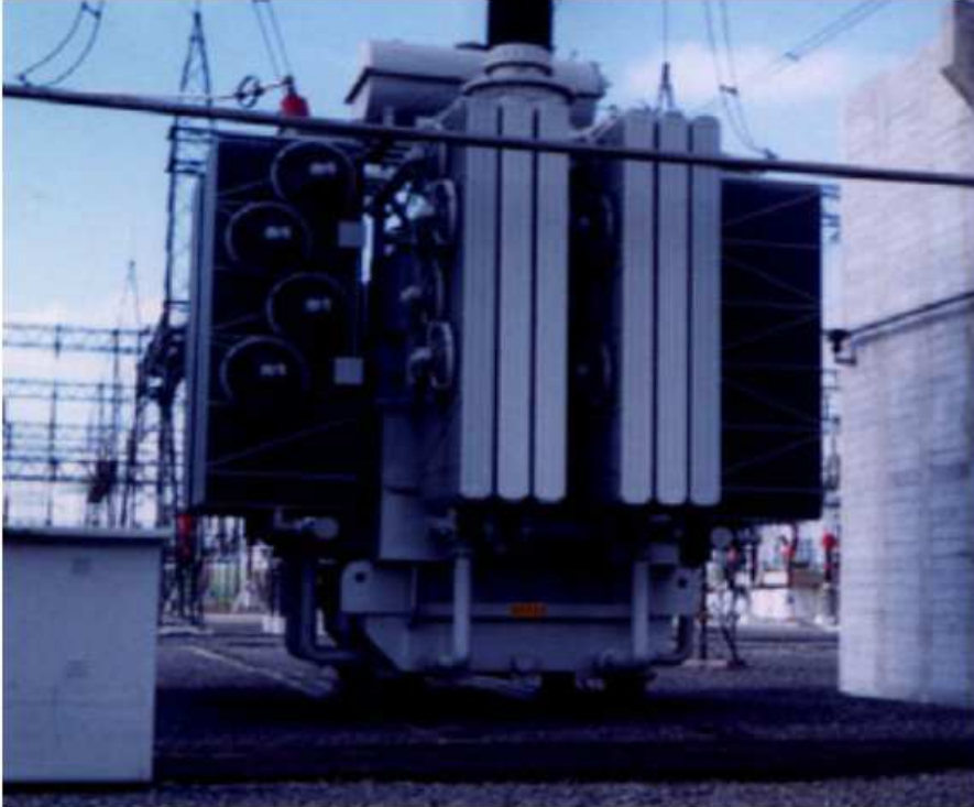
Figura 3: Transformador de alta potencia.
