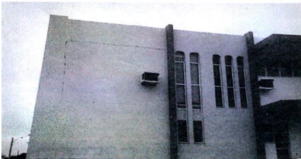
Figura 21: Patologia característica devida retração da alvenaria.
