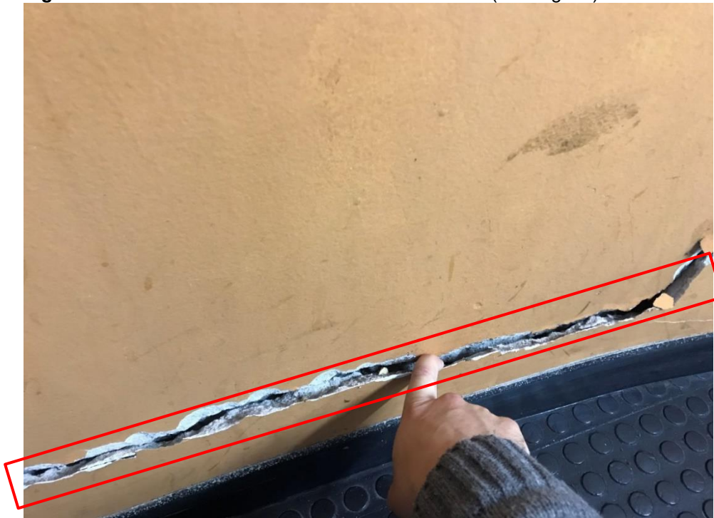
Figura 66: Abertura horizontal do lado direito do teatro (Patologia 4).
