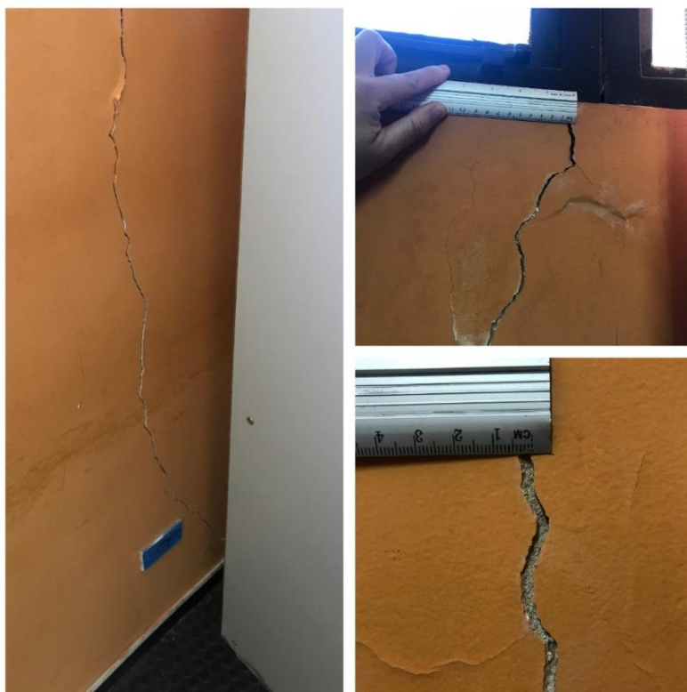
Figura 64: Medições da Patologia 3.
