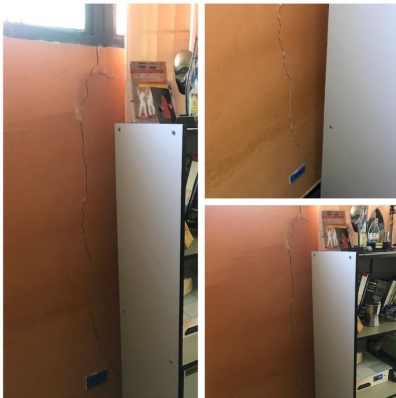
Figura 63: Detalhamento da patologia 3.
