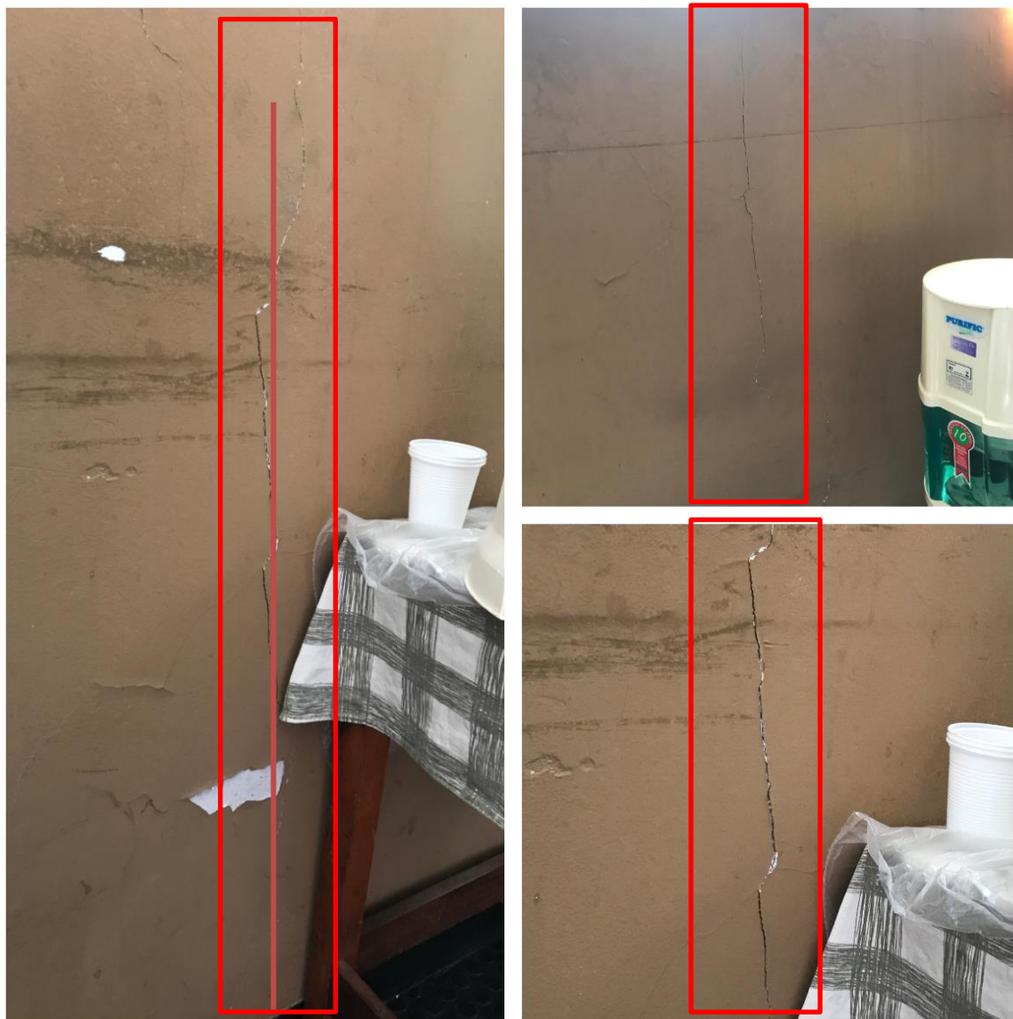
Figura 65: Abertura vertical do lado esquerdo do teatro (patologia 3).
