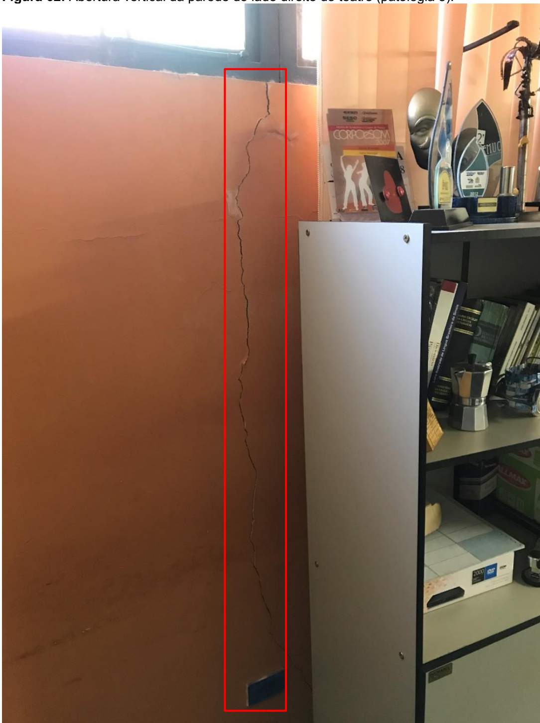
Figura 62: Abertura vertical da parede do lado direito do teatro (patologia 3).
