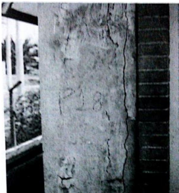
Figura 29: Trincas e fissuras presentes em pilares devido ao aumento da área de armadura após sua corrosão.
