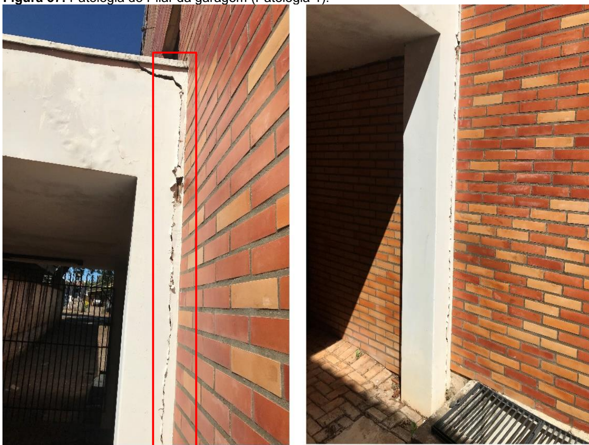
Figura 57: Patologia do Pilar da garagem (Patologia 1).
