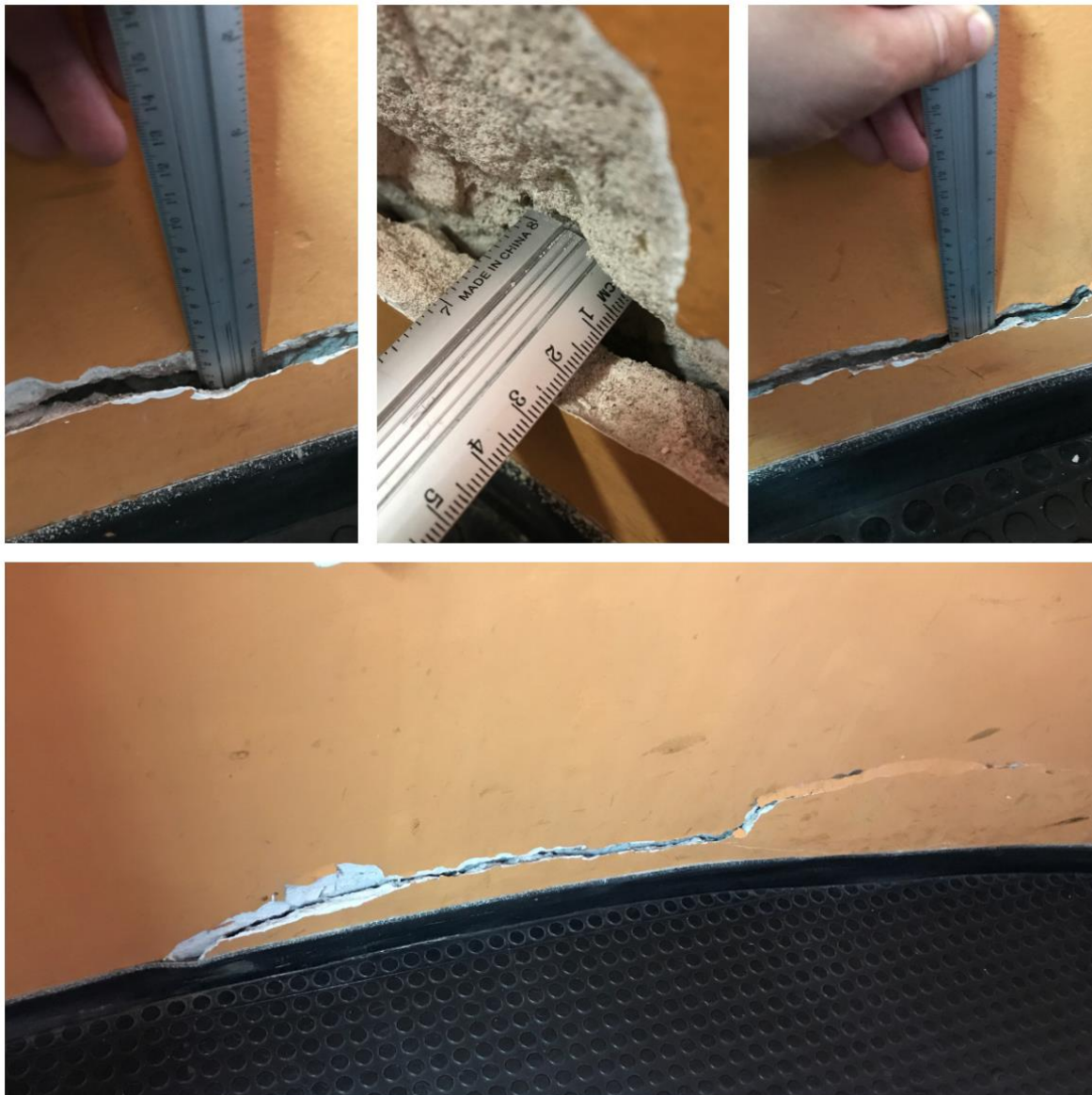
Figura 68: Medições da Patologia 4.
