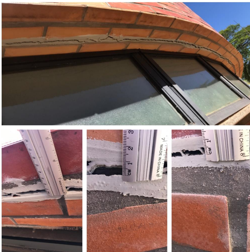
Figura 70: Medições da Patologia 5.
