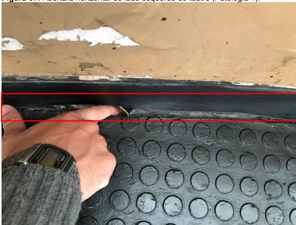
Figura 67: Abertura horizontal do lado esquerdo do teatro (Patologia 4).
